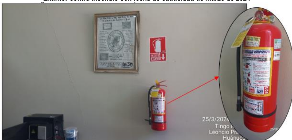
Panel Fotográfico n.º 10 Extintor contra incendio con fecha de caducidad de marzo de 2024
