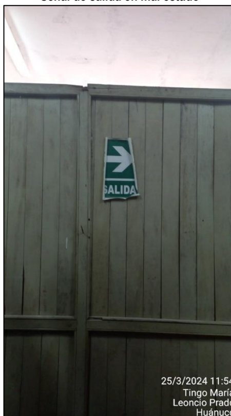
Panel Fotográfico n.º 11 Señal de salida en mal estado
