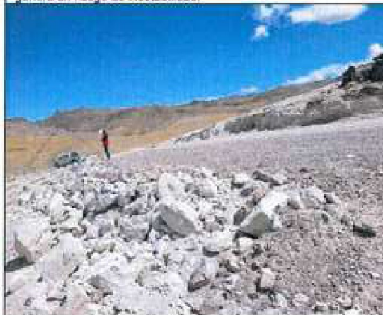
Imagen fotográfica n.º 31: Tramo Km 35+820 a Km 35+970: Material excedente compuesto principalmente por tierra y piedras medianas, presenta las mismas características del terreno de corte, genera un riesgo de inestabilidad.
