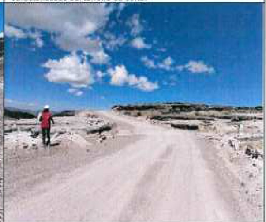
Imagen fotográfica n.º 32: Tramo Km 36+940 a Km 37+060: Material excedente compuesto principalmente por tierra y piedras medianas, presenta las mismas características del terreno de corte, genera un riesgo de inestabilidad.
