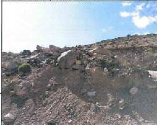
Imagen fotográfica n.º 27: Tramo Km 28+440 a Km 28+520: Material excedente compuesto principalmente por piedras medianas y grandes, presenta las mismas características del terreno de corte, genera un riesgo de inestabilidad.
