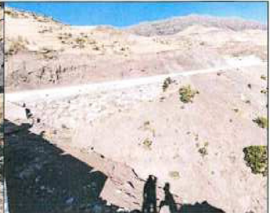
Imagen fotográfica n.º 18: Tramo KM 7+000 a KM 7+100: Material excedente compuesto principalmente por tierra y piedras medianas, presenta las mismas características del terreno de corte, genera un riesgo de inestabilidad.
