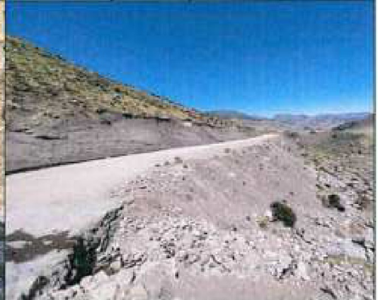
Imagen fotográfica n.º 20: Tramo Km 14+500 a Km 14+600: Material excedente compuesto principalmente por tierra y piedras medianas, presenta las mismas características del terreno de corte, genera un riesgo de inestabilidad.
