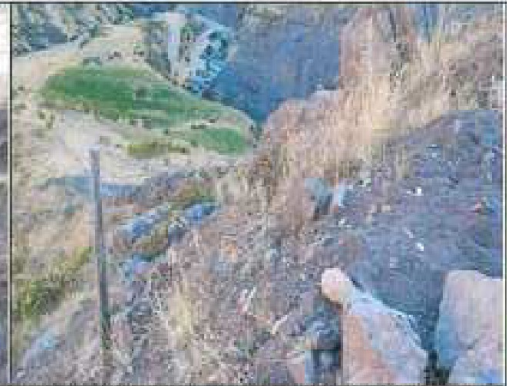
Imagen fotográfica n.º4: DME-1 ubicado en la progresiva Km 4 +150 (a lado izquierdo de la carretera), en las coordenadas UTM, N: 8545271; E: 461369, se evidencia piedras de gran tamaño dejado al borde de la vía.
