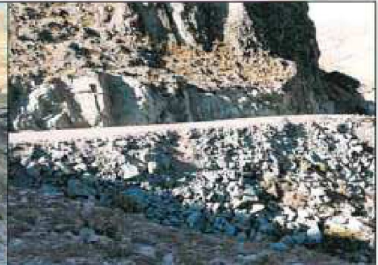
Imagen fotográfica n.º 24: Tramo Km 21+780 a Km 21+790: se observa piedras que presenta las mismas características del terreno de corte de la conformación de la plataforma de rodadura, ubicada al frente del material eliminado.
