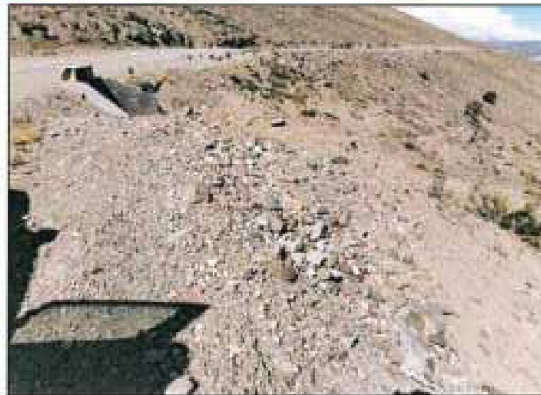
Imagen fotográfica n.º 29: Tramo Km 28+880 a Km 28+910: Montículo de material excedente compuesto de piedras y tierra, producto de la excavación para la construcción de alcantarilla, genera un riesgo de inestabilidad.
