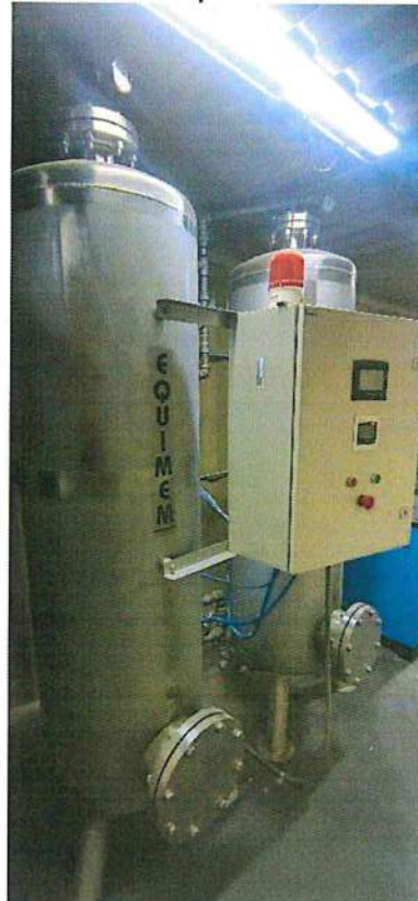
Toma Fotográfica n.º 8 Generador de oxígeno medicinal sin placa de identificación de datos técnicos
