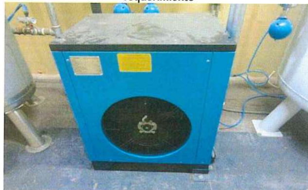
Toma Fotográfica n.º 12 Sistema de secador que no está incorporado al generador de oxígeno conforme lo indicaba el requerimiento
