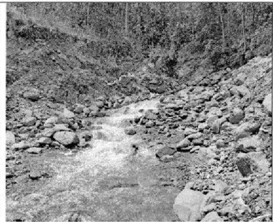
Fotografía n.º 16: Se observa que en la progresiva 0+010 río arriba medido desde el puente, se observa que el cauce del río se encuentra sin trabajos de encausamiento y descolmatación, puesto que no forma una sección de canalización de escurrimiento continuo.
