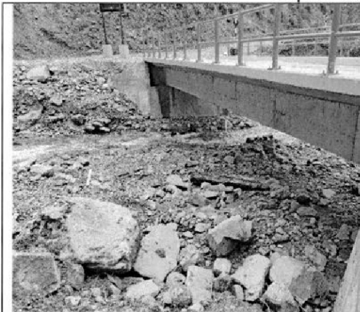
Fotografía n.º 15: En la progresiva 0+000 río arriba medido desde el puente, se observa que el cauce del río se encuentra sin trabajos de encausamiento y descolmatación, puesto que no forma una sección de canalización de escurrimiento continuo.
