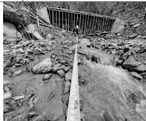
Fotografía n.º 12: Se observa que en la progresiva 0+014 río abajo medido desde el puente, se observa que el cauce del río se encuentra sin trabajos de encausamiento y descolmatación, puesto que no forma una sección de canalización.
