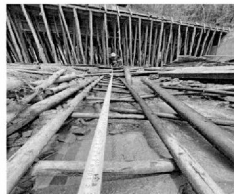
Fotografía n.º 11: Se observa que en la progresiva 0+007 río abajo medido desde el puente, se observa que el cauce del río se encuentra sin trabajos de encausamiento y descolmatación, puesto que no forma una sección de canalización.
