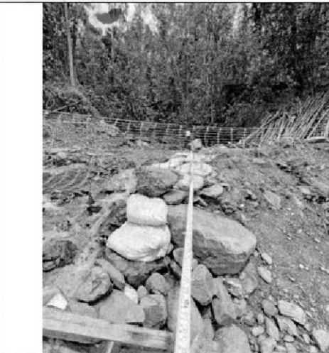
Fotografía n.º 9: En la progresiva 0+014 río arriba medido desde el puente, se observa que el cauce del río se encuentra sin trabajos de encausamiento y descolmatación, puesto que no forma una sección de canalización con las medidas: ancho de 3.20 m y alto de 2.50 m
