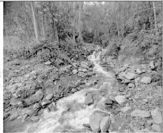
Fotografía n.º 18: Se observa que en la progresiva 0+030 río arriba desde el puente, se observa que el cauce del río se encuentra sin trabajos de encausamiento y descolmatación, puesto que no forma una sección de canalización con las medidas: ancho de 3.20 m y alto de 2.50 m.
