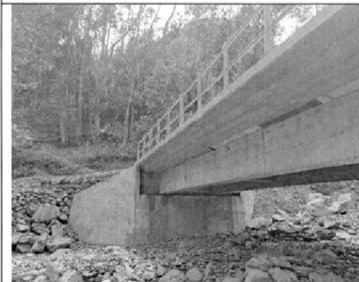
Fotografía n.º 19: Se observa que en la progresiva 0+000 río abajo medido desde el puente, se observa que el cauce del río se encuentra sin trabajos de encausamiento y descolmatación, puesto que no forma una sección de canalización.
