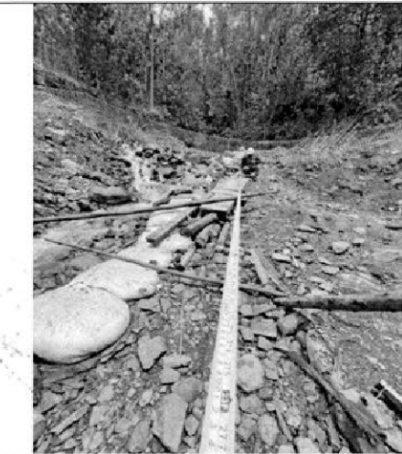
Fotografía n.º 10: Se observa que en la progresiva 0+007 río arriba desde el puente, se observa que el cauce del río se encuentra sin trabajos de encausamiento y descolmatación, puesto que no forma una sección de canalización con las medidas: ancho de 3.20 m y alto de 2.50 m.
