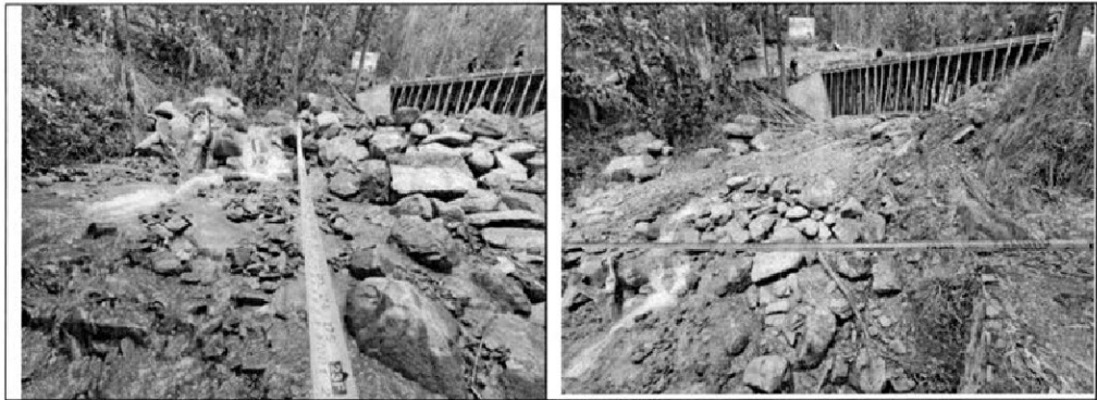
Fotografías n.º 13 y 14: Se observa que en la progresiva 0+021 río abajo medido desde el puente, se observa que el cauce del río se encuentra sin trabajos de encausamiento y descolmatación, puesto que no forma una sección de canalización.
