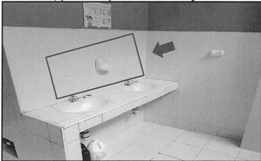
Imagen n.º 19 Espejo biselado no ejecutado en los servicios higiénicos
