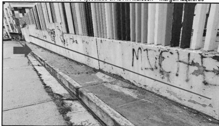
Imagen n.º 5 Contra zócalo exterior no ejecutado en la Av. Malecón – margen izquierdo
