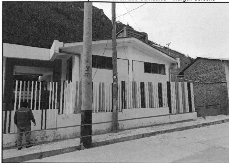
Imagen n.º 6 Contra zócalo exterior no ejecutado en Jr. Los Guindales – margen derecho
