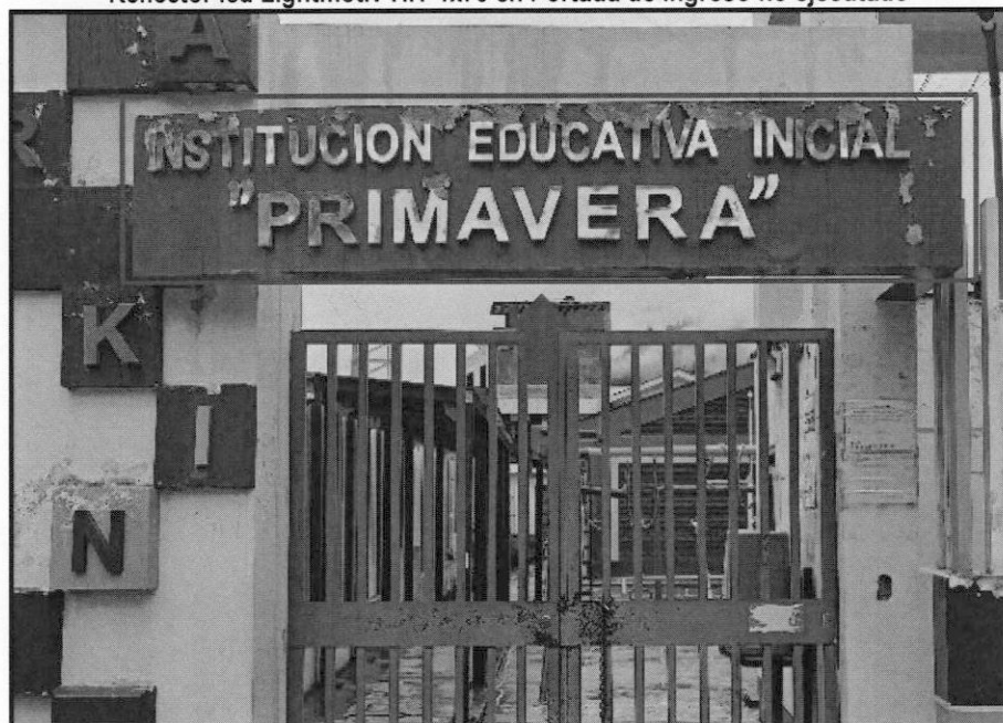
Imagen n.º 17 Reflector led Lightmotiv HIT 1x70 en Portada de ingreso no ejecutado
