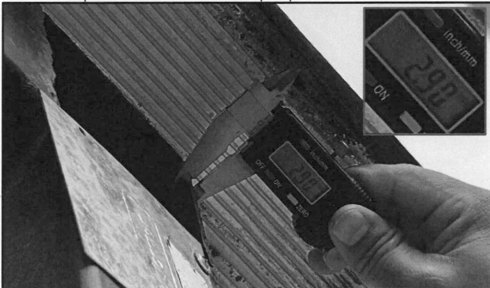
Imagen n.º 83 Espesor menor a 3/16" en estructura principal de circulación techada
