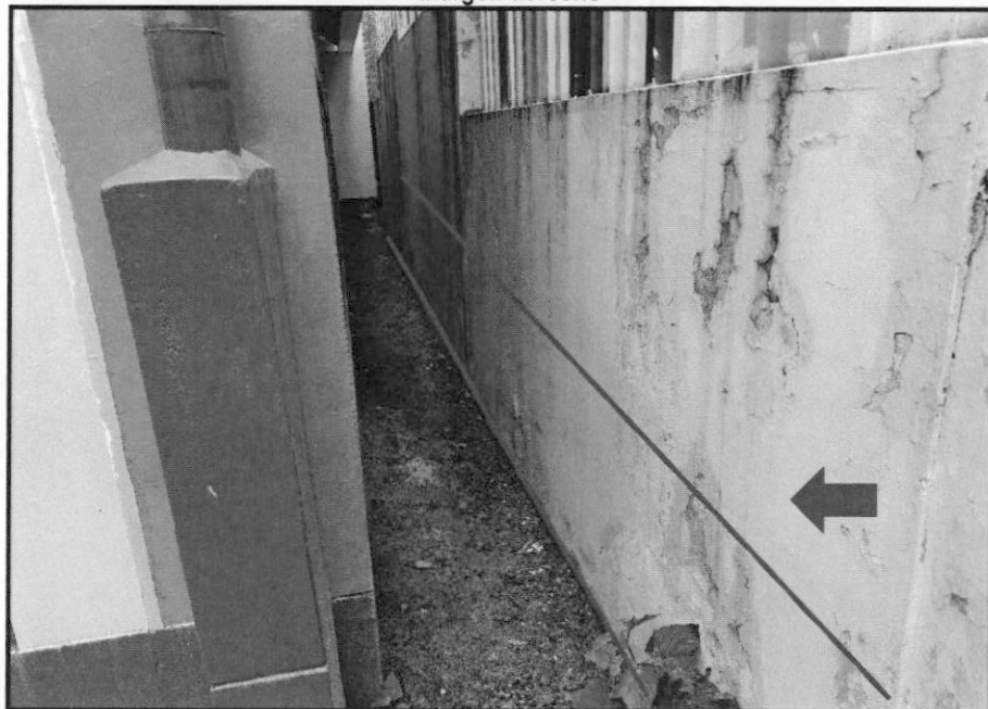
Imagen n.º 7 Contra zócalo interior no ejecutado en Muro ubicado junto al Jr. Los Guindales – margen derecho
