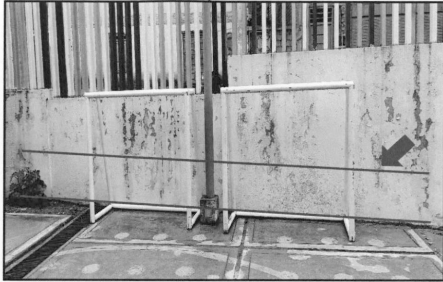
Imagen n.º 8 Contra zócalo interior no ejecutado en Muro ubicado junto a Jr. Los Guindales – margen derecho
