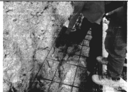
Fotografía n.º 8: Se visualiza, que el espaciamento entre las varillas de acero de refuerzo transversal varía entre 15 cm a 25 cm.
