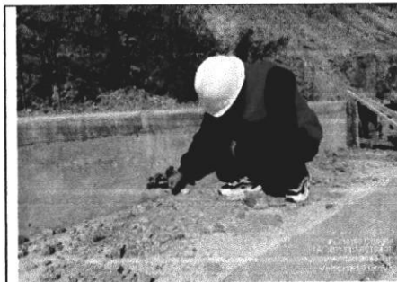
Fotografía n.º 9: Se visualiza, cangrejas por un mal proceso constructivo, por una mala o inexistente dirección técnica.
