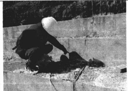
Fotografía n.º 10: Se visualiza, fisuras en las gradas de la tribuna sur.
