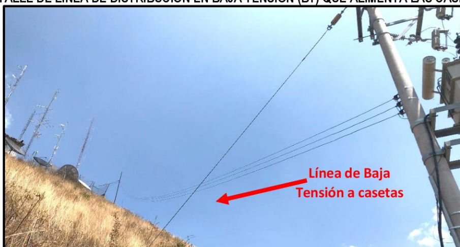
IMAGEN N° 7 DETALLE DE LÍNEA DE DISTRIBUCIÓN EN BAJA TENSIÓN (BT) QUE ALIMENTA LAS CASETAS
