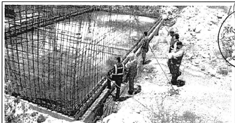
Foto N° 23.- RAFA PTAR proyectado
