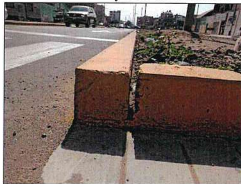
Imagen n.º 37 Falta sellado de juntas en sardineles
