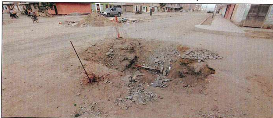
Imagen n.º 19 Zona de empalme de red de agua potable en área de pavimento vehicular
