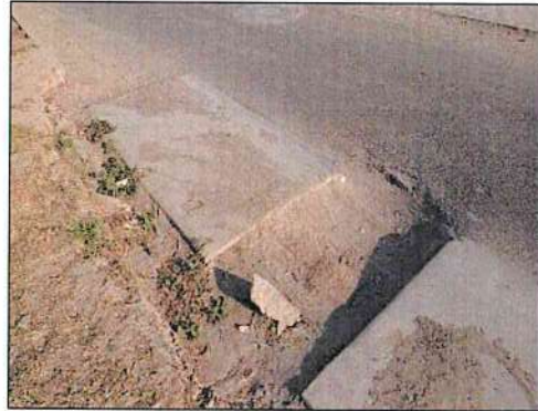
Imagen n.º 53 Falta reposición de pavimento en Av. Huamán
