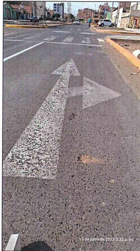
Imagen n.º 71 Hueco en carpeta asfáltica en Av. Juan Pablo II
