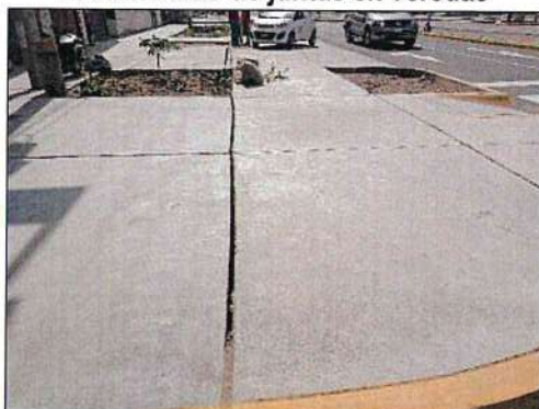
Imagen n.º 34 Falta sellado de juntas en veredas
