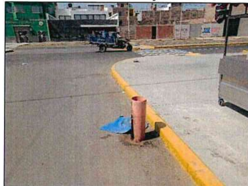
Imagen n.º 51 Señalización no ejecutada
