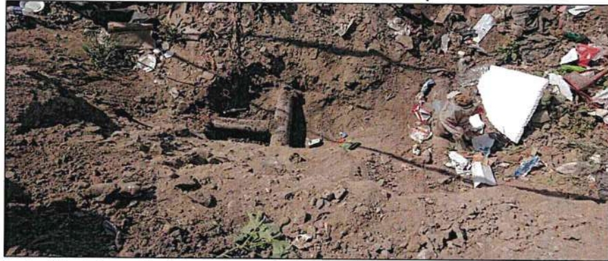
Imagen n.º 16 Zona de empalme de red de agua potable en área de pavimento vehicular
