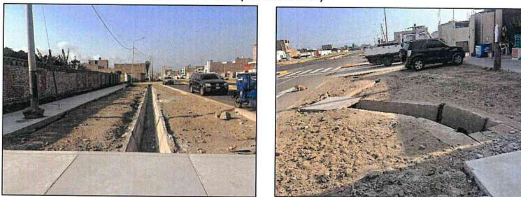
Imágenes n.ºs 12 y 13 Canal sin techo (sin intervenir)
