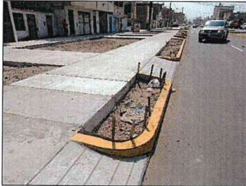
Imagen n.º 40 Encofrado de sardinel no retirado
