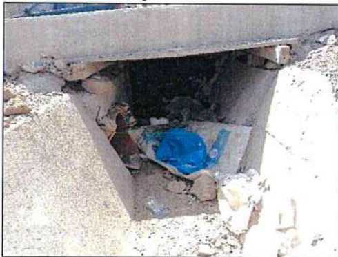
Imagen n.º 42 Desencofrado de techo de canal no ejecutado
