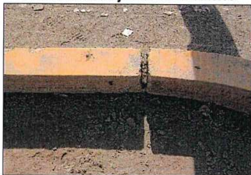
Imagen n.º 38 Falta sellado de juntas en sardineles
