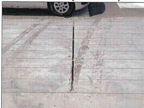
Imagen n.º 36 Falta sellado de juntas en rampas
