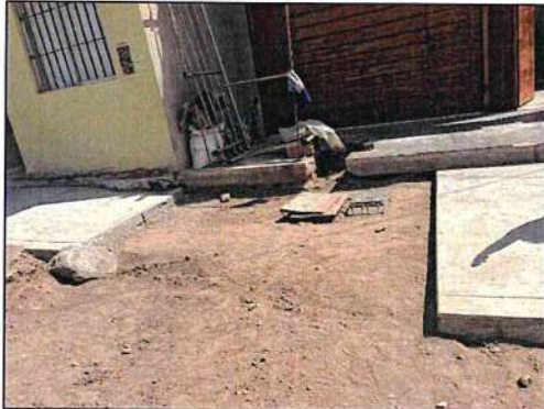
Imagen n.º 48 Vereda no ejecutada
