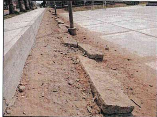
Imagen n.º 47 Falta limpieza de obra
