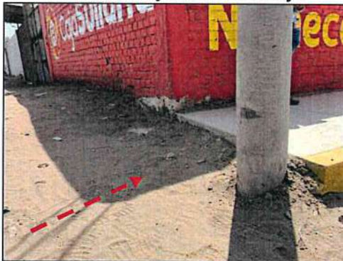
Imagen n.º 44 Martillo no ejecutado en intersección de Av. Juan Pablo II y Av. Dos de Mayo
