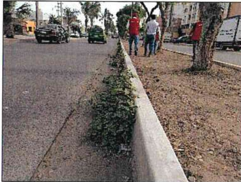
Imagen n.º 52 Falta reposición de pavimento en Av. Larco
