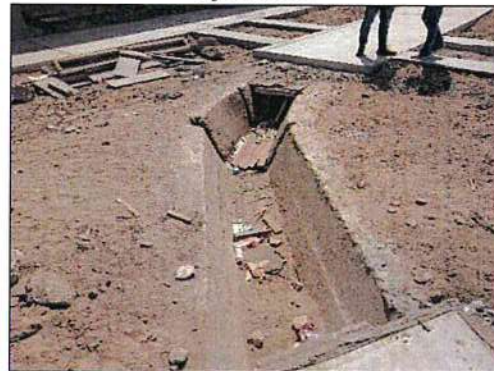
Imagen n.º 43 Desencofrado de techo de canal no ejecutado
