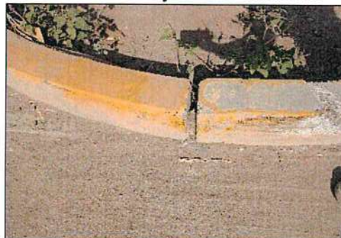
Imagen n.º 39 Falta sellado de juntas en sardineles
