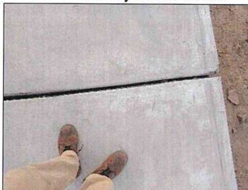
Imagen n.º 35 Falta sellado de juntas en veredas
