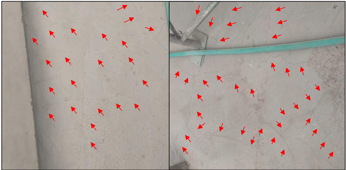
Imagen n.º 18 y 19 Fisuras en pasarela ubicada entre la plata de espectadores y proscenio del bloque B del edificio 1
