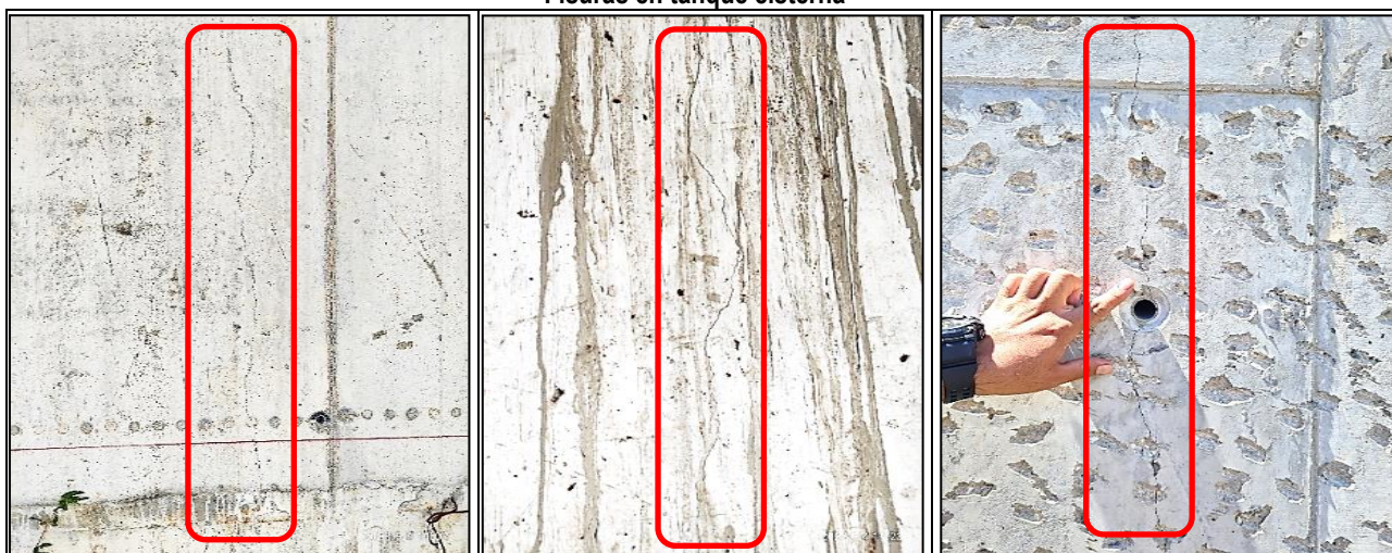
Imágenes n.ºs 65, 66, 67, 68, 69 y 70 Fisuras en tanque cisterna
