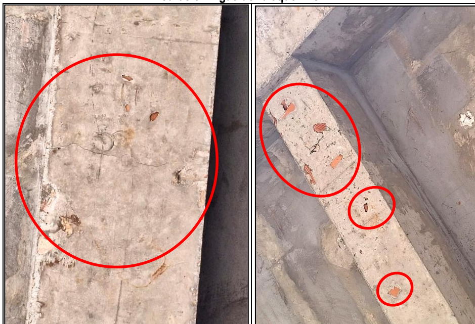
Imágenes n.ºs 71, 72, 73 y 74 Fisuras en vigas del bloque “ES1”
