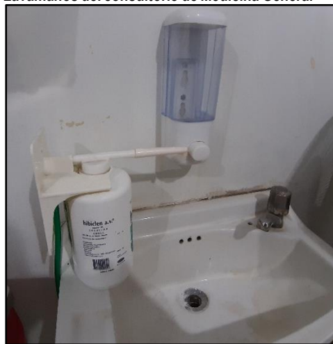
Imagen N° 2 Lavamanos del consultorio de Medicina General
