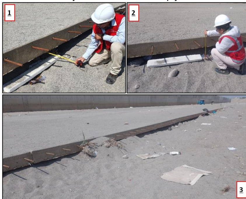
Imagen n.º 15 Socavación y relleno de arena en base de apoyo de losa
