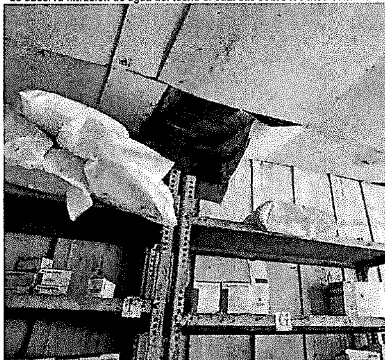
Imagen n.º 5 Se observa filtración de agua del techo el cual cae sobre los medicamentos.
