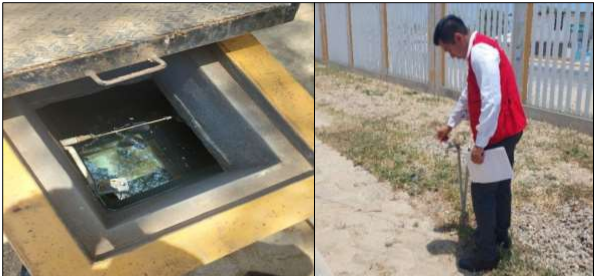
Imagen n.º 5 Y 6 Pozo de agua lleno, sin embargo, en las llaves de agua no hay agua potable.
