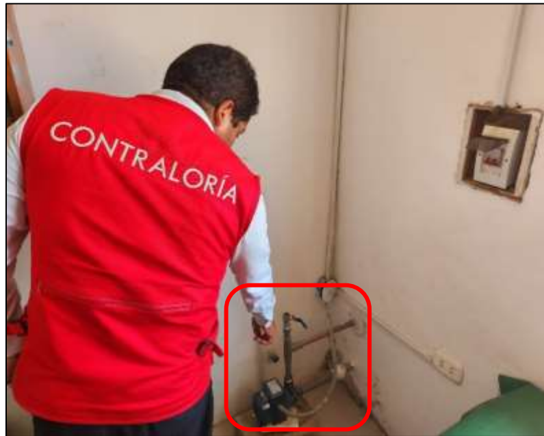
Imagen n.º 4 Existencia de una bomba de agua dentro del consultoría de Medicina General
