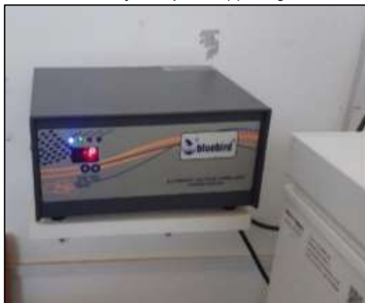
Imagen n.º 14 Estabilizador de Voltaje solo para un (1) Refrigerador Ice Lined
