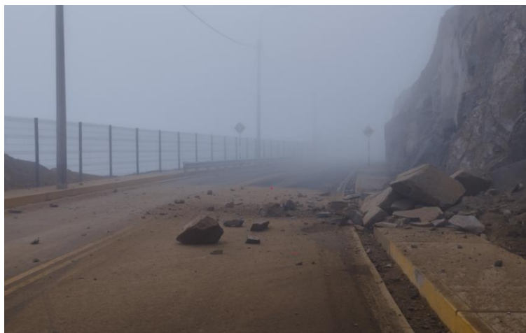
8 de mayo de 2023: Caída de rocas en vereda y pavimento, aproximadamente en km 3+000 de la vía ejecutada.
