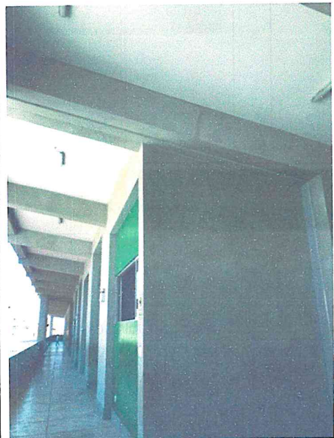
Rajadura en la viga superior del 3° nivel en el bloque de la escalera del pabellón de primaria.
