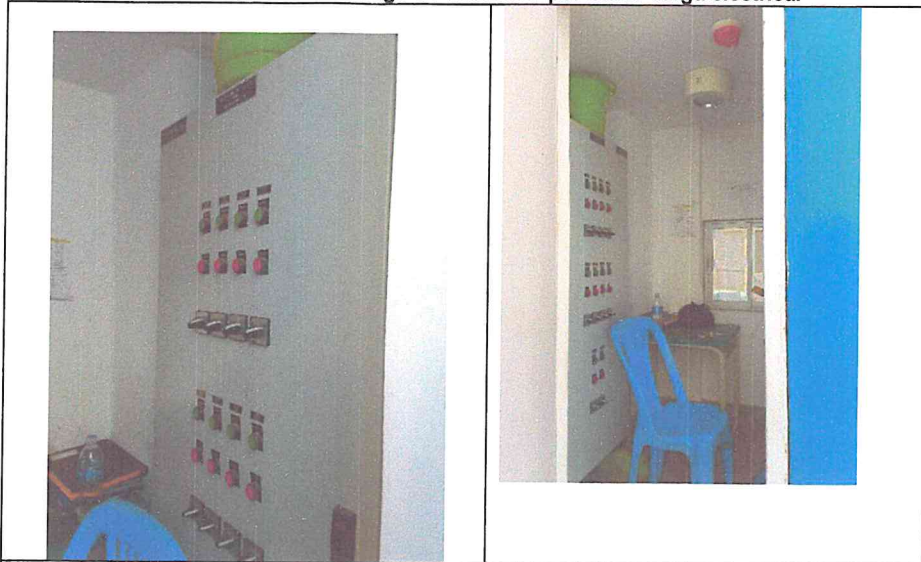
Uso de ambiente que contiene Tablero eléctrico para caseta de vigilancia
