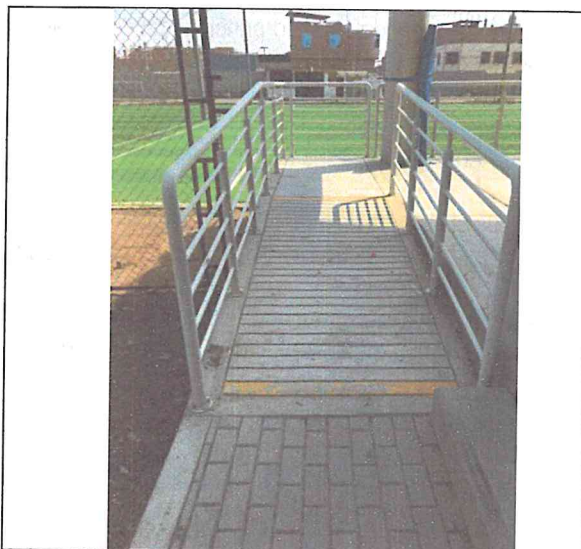
Rampas en el área deportiva sin podotáctiles ni al inicio ni al final.(b)
