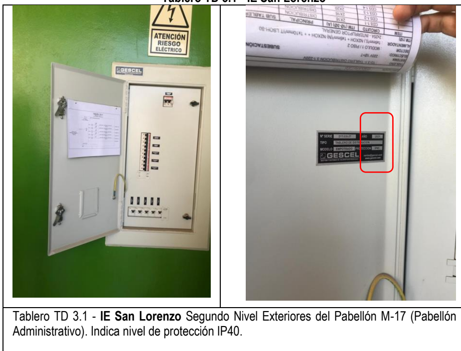
Fotografía N° 17 Tablero TD 3.1 - IE San Lorenzo
