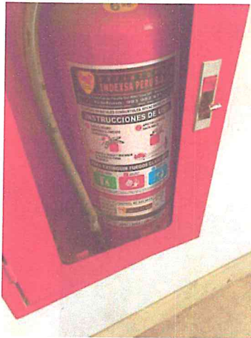
Extintor en el pabellón administrativo caduco y sin vidrios de protección.
