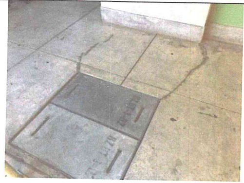
Fisuras en las veredas del patio principal.
