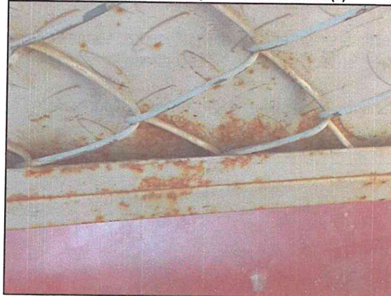
Imagen: Puerta en inicial que muestra el óxido.(a)
