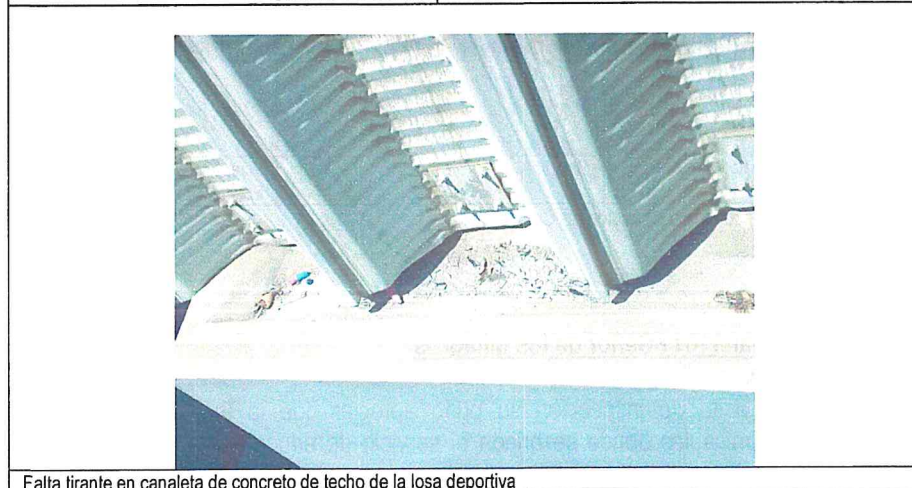
Falta tirante en canaleta de concreto de techo de la losa deportiva
