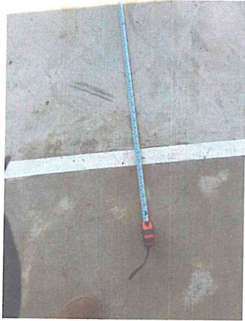
La distancia entre las columnas de la losa deportiva y el área de juegos es de 1.34 m.
