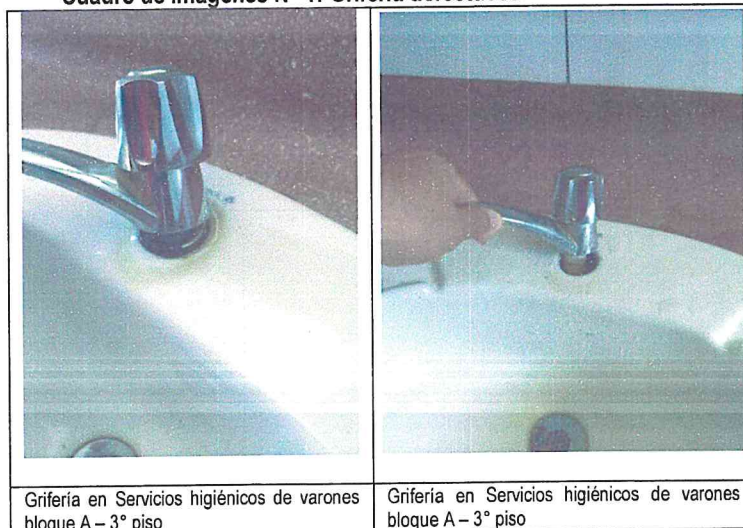
Cuadro de Imágenes N° 1: Grifería defectuosa
