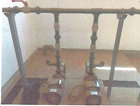
Imagen N° 12: falta señalización e indicaciones de valvulas
