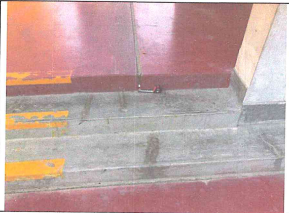
Se pueden observar fisuras en las escaleras del patio principal.
