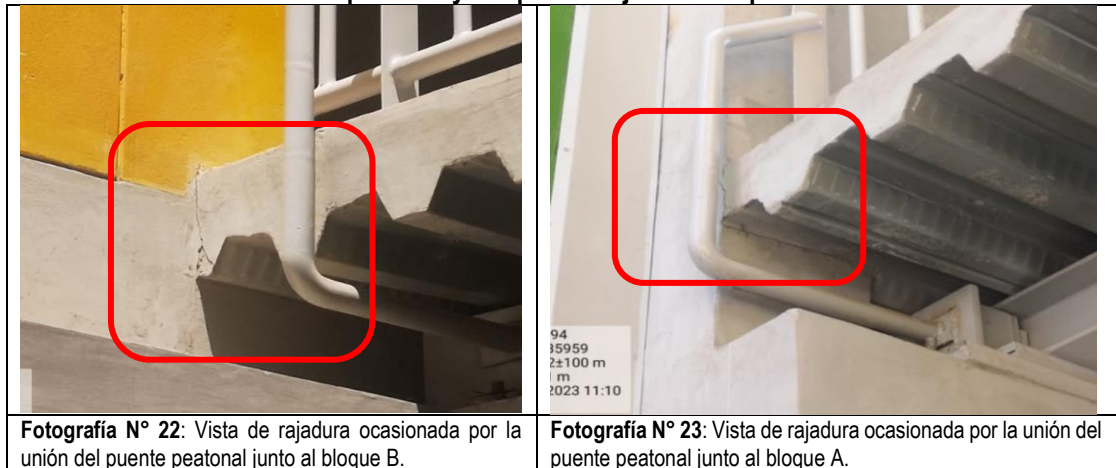
Fotografía N° 22: Vista de rajadura ocasionada por la unión del puente peatonal junto al bloque B. Fuente: Visita de Inspección realizada el 4, 5 y 6 de setiembre de 2023. Elaborado por: Comisión de control Concurrente.
