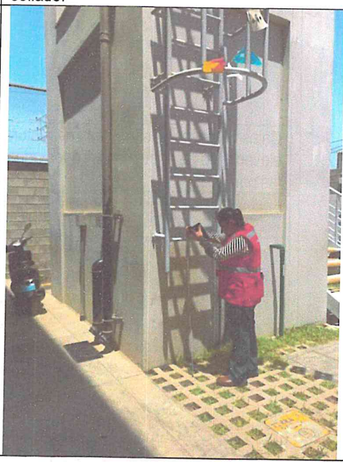
Escalera de acceso al tanque elevado con una altura de 1.28m. No se aprecia una rejilla de seguridad.
