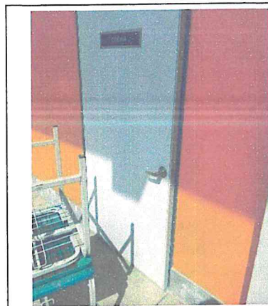
Puerta no cierra en la Cocina de educación inicial – Bloque D
