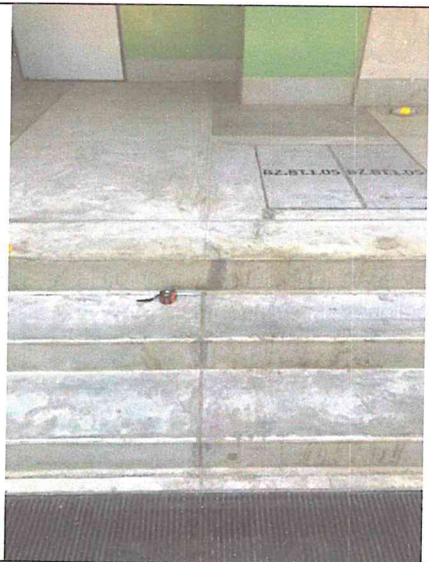
Se pueden observar fisuras en las escaleras del patio principal.
