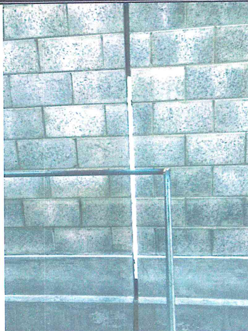
Fisuras en el cerco perimétrico sin sellado exterior.
