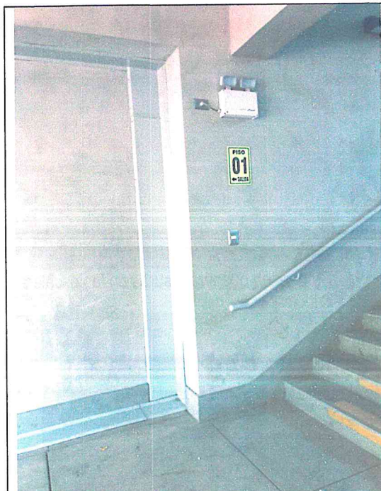
Se observa que las tapajuntas metálicas son retaceadas.
