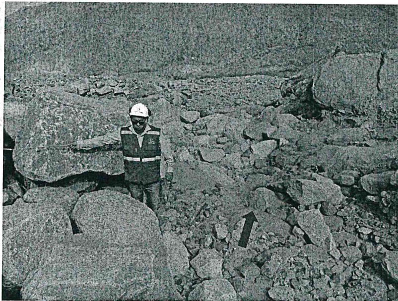
Vista de dique 23 culminado. Socavación margen derecho de poza de amortiguamiento, por efecto del incremento del caudal a consecuencia del evento Yaku.
