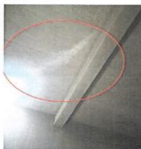
Presencia de fisuras en interior de losa de techo de cisterna de PTAP
