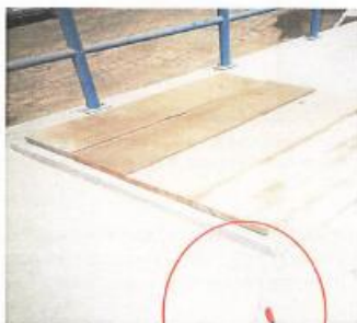
Presencia de Fisuras externas en la losa de techo de cisterna de PTAP
