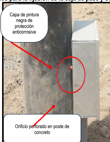
Imagen N° 13 – Postes de concreto armado en la PTAP, con orificios perforados para la fijación de la caja de pase y derivación
