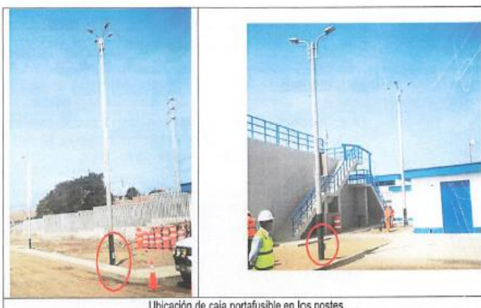
Ubicación de caja portafusible en los postes
