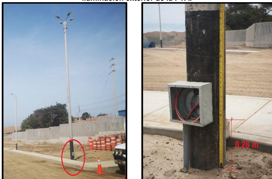
Imagen N° 12 – Cajas de pase y derivación en los postes de concreto para iluminación exterior de la PTAP
