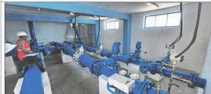
Interior de Reservorio R-3 con árbol hidráulico instalado.
