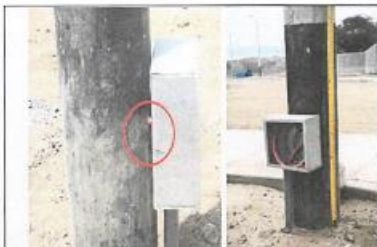
Perforación en los postes de concreto de iluminación exterior. Caja eléctrica portafusibles con una altura de la parte inferior de la caja al terreno de 0,28m del suelo.
