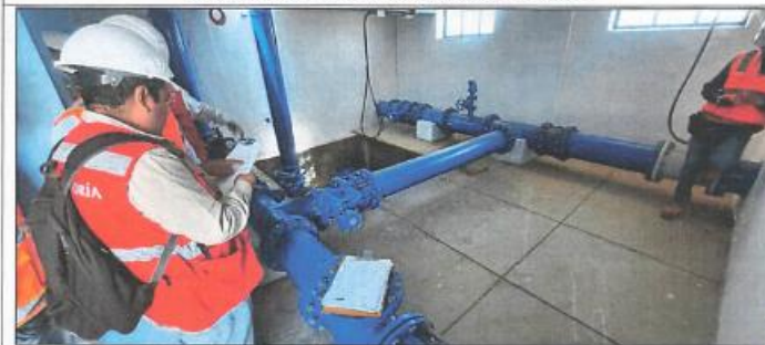
Interior de Reservorio R-1 con árbol hidráulico instalado.
