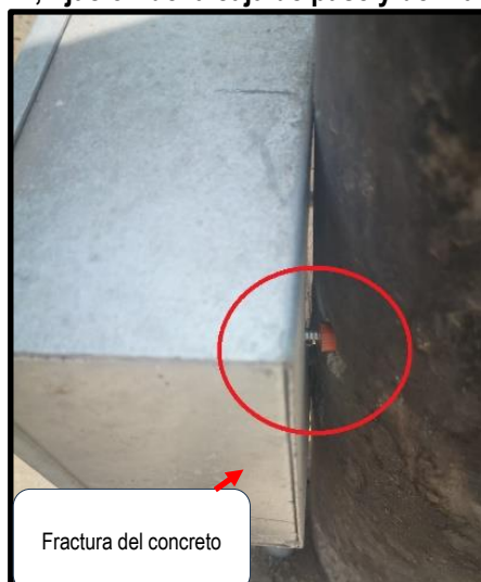
Imagen N° 14 – Fractura de la superficie del Postes de concreto armado en la PTAP, fijación de la caja de pase y derivación
