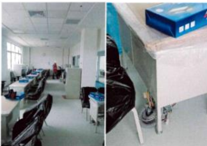
Vistas del mobiliario instalado en los ambientes administrativos, e instalaciones pendientes de instalación de toma eléctrica y red.
