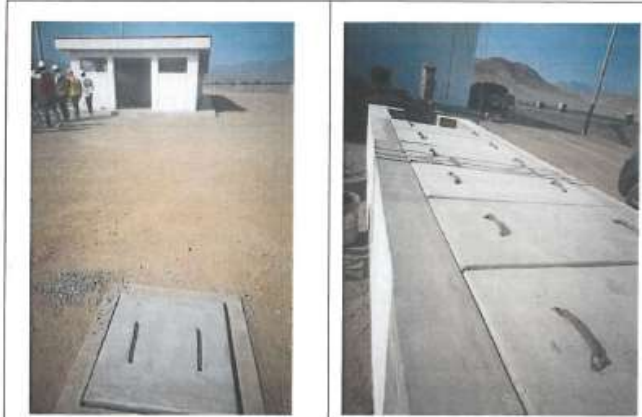
Las asas metálicas de las tapas de concreto han sido fabricadas con acero corrugado.
