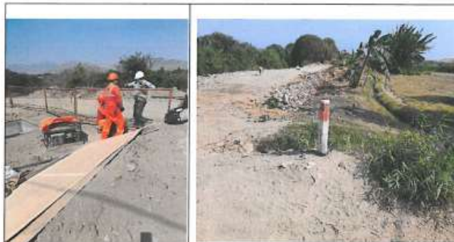
Ejecución de cámaras de aire y purga en el camino de ingreso a la PTAR
