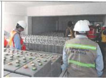
Cuarto de baterías - Sistema de paneles fotovoltaicos –zona de pre-tratamiento.
