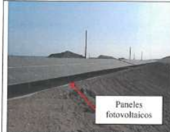
Sistema de paneles fotovoltaicos – cerca a zona de pre-tratamiento
