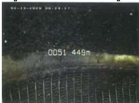
Imagen N° 10 - Unión de Tubería ciega- Filtro
