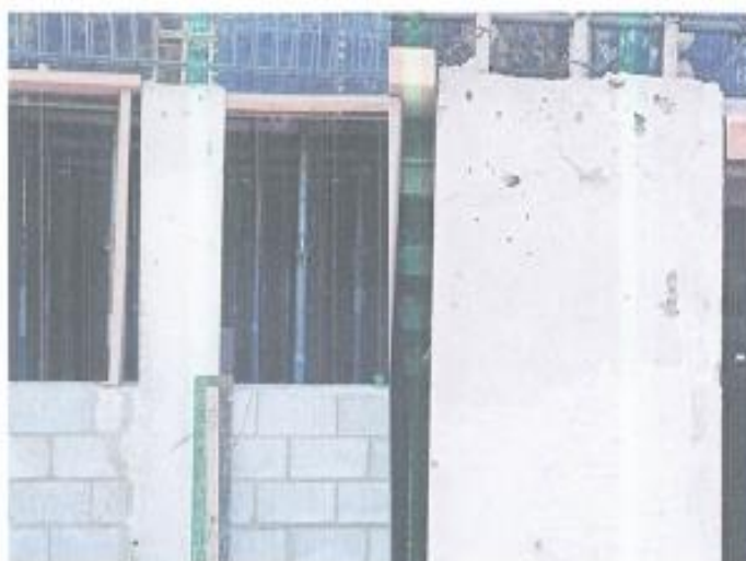
Presencia de fisuras en columna en la zona de Residencia en el Módulo M3, primer piso.
