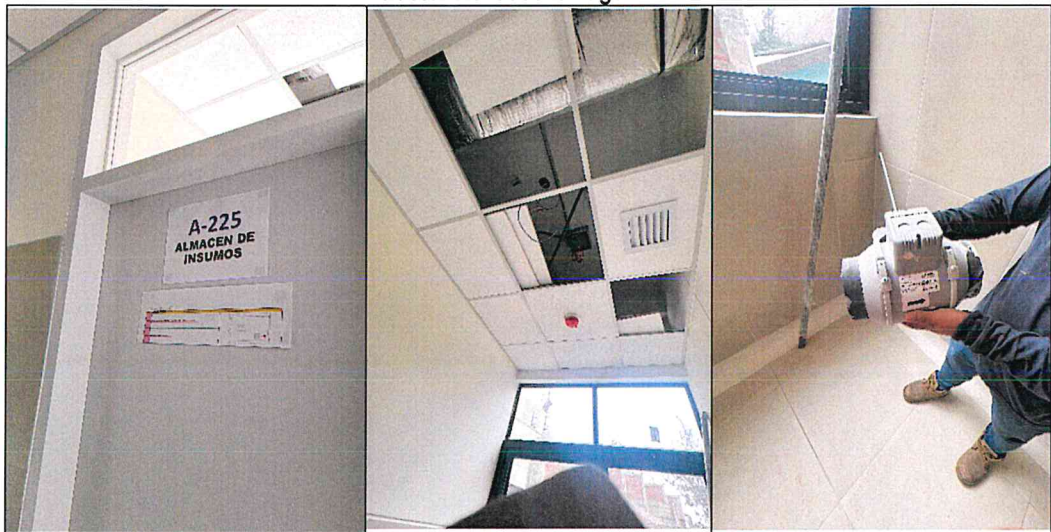
Imágenes n.ºs 21, 22 y 23 Almacén de Insumos – Área A-225 Extractor Helicocentrífugo EHC – 212
