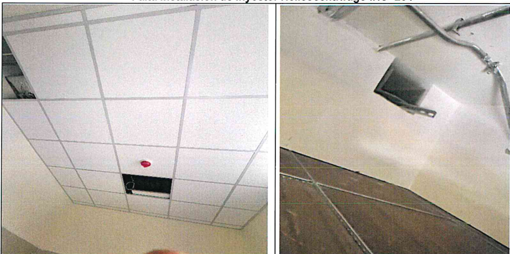
Imágenes n.ºs 27 y 28 Falta instalación de Inyector Helicentrífugo IHC -204
