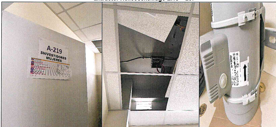
Imágenes n.ºs 15, 16 y 17 SSHH Vestidores Mujeres– Área A-219 Extractor Helicocentrífugo EHC – 207
