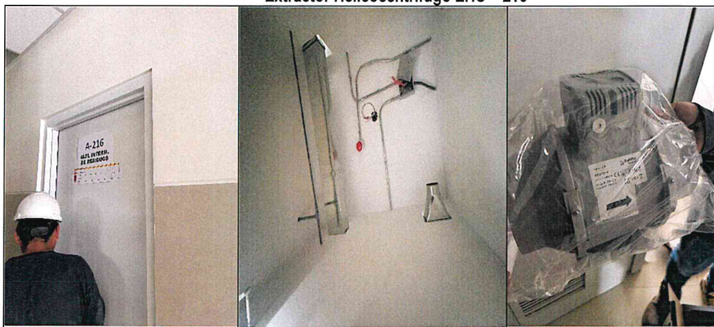
Imágenes n.ºs 9, 10 y 11 Almacén Inter. Residuos– Área A-216 Extractor Helicocentrífugo EHC – 210
