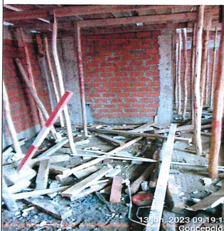
Fotografía n.º 7: En el ambiente del cafetín se observa tabloncillos del encofrado.
