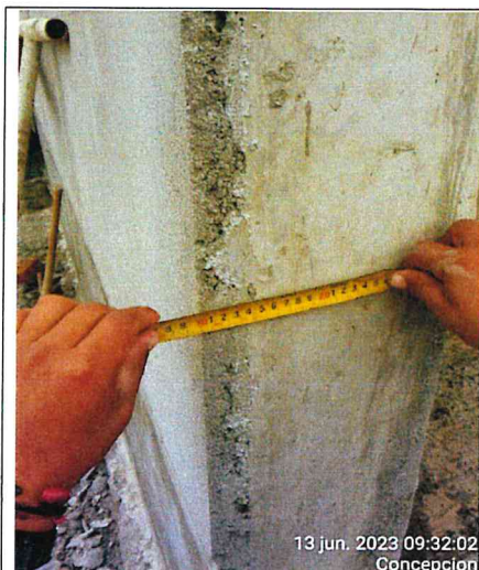
Fotografía n.º 5: En el cafetín se observa que el espesor del tarrajeo en muro exterior es mayor a 3cm.
