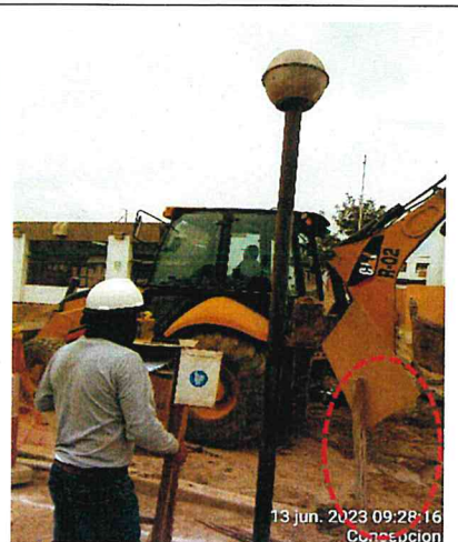
Fotografía n.º 12: Rotura de tubería de agua existente por trabajos con maquinaria pesada.
