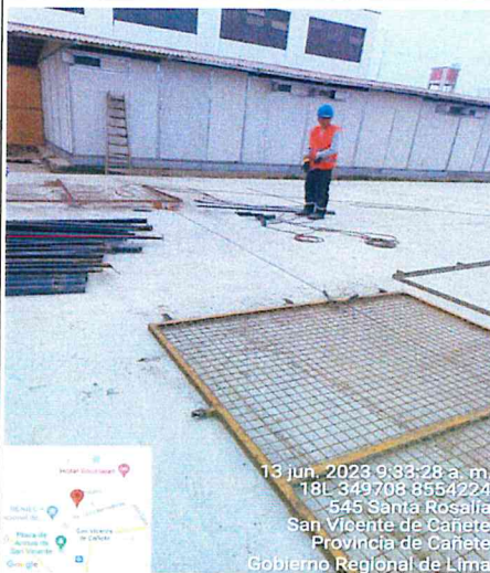
Fotografía n.º 13: Personal realizando trabajos de soldadura, sin lentes de seguridad.
