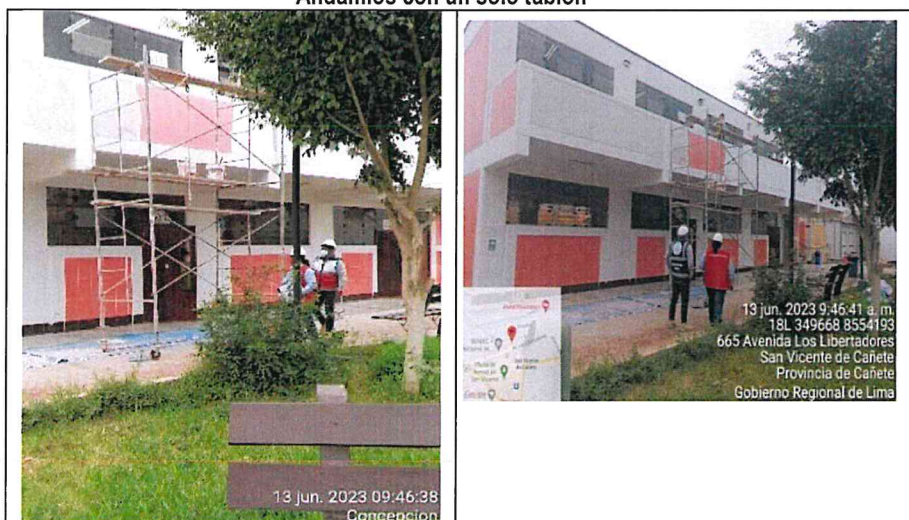
Imágenes n.ºs 8 y 9 Andamios con un solo tablón
