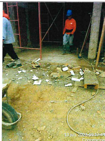
Fotografía n.º 9: Restos de madera del encofrado en el ingreso al cafetín.
