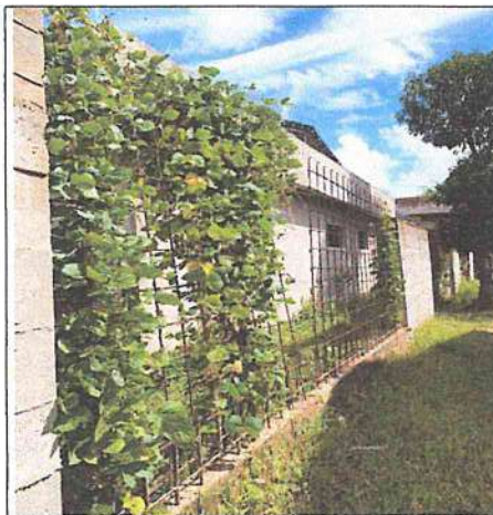
Fotografía n.º 11: En la vista se observó que solamente se ejecutó 3 muros de concreto del tramo 1 del cerco perimétrico.
