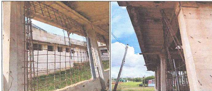
Fotografías n.º 59 y 60: En la vista se observó aceros de refuerzo totalmente oxidados, correspondientes a muros de concreto de la UPS prevención y control de TBC.
