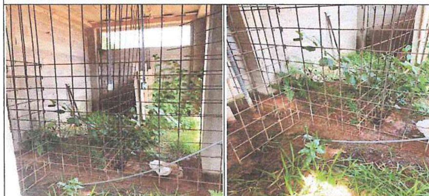
Fotografías n.º 55 y 56: En la vista se observó aceros de refuerzo totalmente oxidados, correspondientes a muros de concreto de la UPS salud ambiental.
