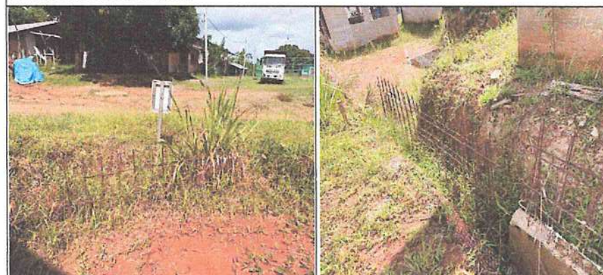
Fotografías n.º 57 y 58: En la vista se observó aceros de refuerzo totalmente oxidados y a la intemperie, correspondientes a sobrecimientos de los tramos 4, 7 y 8 del cerco perimétrico.
