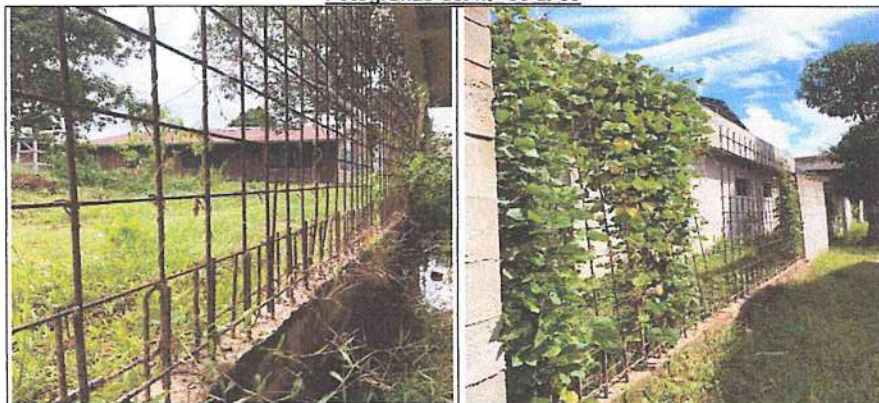
Fotografías n.º 53 y 54: En la vista se observó aceros de refuerzo totalmente oxidados y a la intemperie, correspondientes a muros de concreto del tramo 1 del cerco perimétrico.
