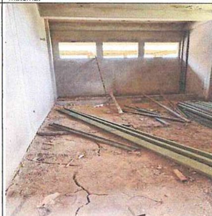
Fotografía n.º 22: En la vista se observó la inyección de falso piso y contrapiso en el ambiente de SUM.
