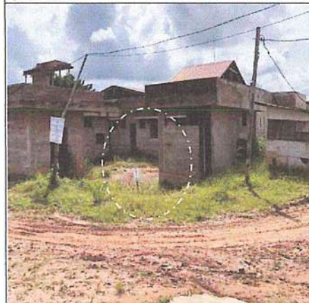
Fotografía n.º 13: En la vista se observó la inyección de armado de correas ni cobertura en tanque de petróleo.
