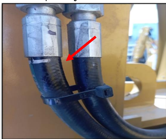
Imagen n.º 18 Retroexcavadoras con serie N° CLW009LDTPN001784, presenta fuga de aceite hidráulico en el prensado de los acoples de manguera de estabilizadores
