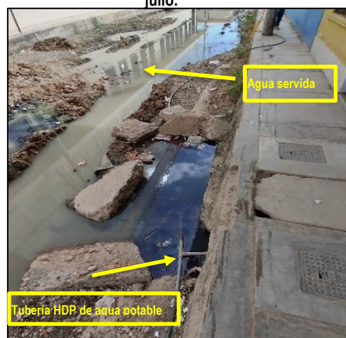
Imagen n.º 8 Tubería HDP para agua potable en calle Jorge Herrera, en la última cuadra llegando a calle 24 de julio.
