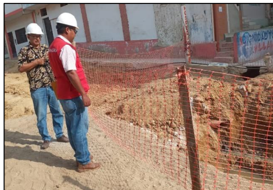
Imagen n.º 10 Inicio de recorrido de agua servida en la calle Mayor Novoa
