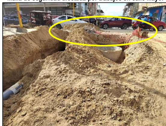
Imagen n.º 30 Malla de seguridad afectada por trabajos en calle Mayor Novoa
