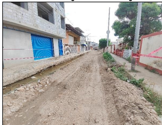
Imagen n.º 28 Cerco con cinta de seguridad en calle Jorge Herrera
