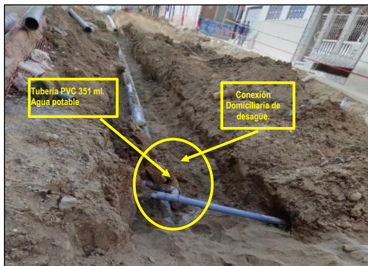
Imagen n.º 3 Fuga de agua servida en conexión domiciliar en calle Mayor Novoa.
