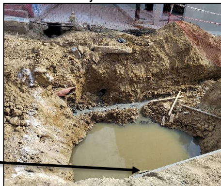
Imagen n.º 9 Inicio de recorrido de agua servida en la calle Mayor Novoa
