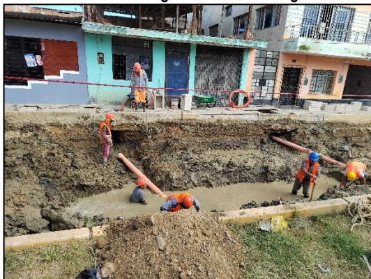
Imagen n.º 27 Cerco con cinta de seguridad en calle Jorge Herrera
