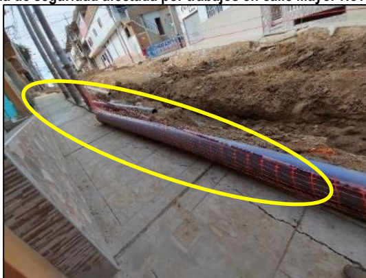
Imagen n.º 29 Malla de seguridad afectada por trabajos en calle Mayor Novoa.
