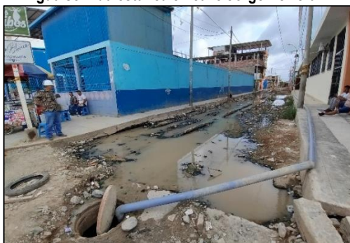
Imagen n.º13 Agua servida estanca en calle Jorge Herrera
