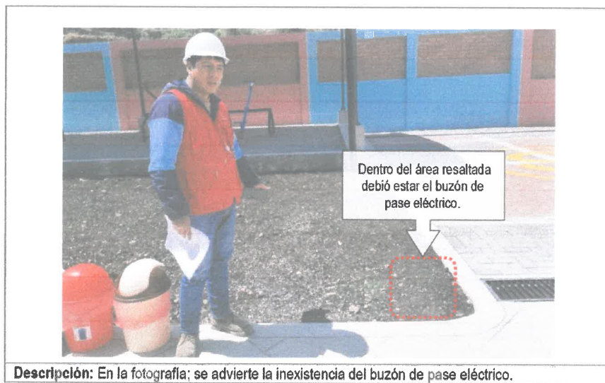
Imagen n.º 24 Panel Fotográfico n.º 19, de 28 de agosto de 2023, de partidas no ejecutadas
