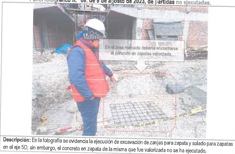
Imagen n.º 42 Panel fotográfico n.º 08, de 9 de agosto de 2023, de partidas no ejecutadas.
