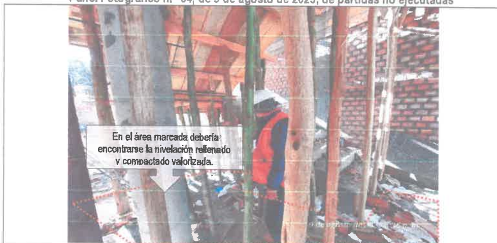
Imagen n.º 34 Panel Fotográfico n.º 04, de 9 de agosto de 2023, de partidas no ejecutadas
