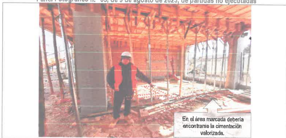
Imagen n.º 31 Panel Fotográfico n.º 03, de 9 de agosto de 2023, de partidas no ejecutadas
