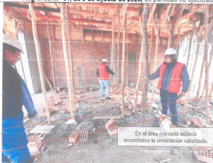
Imagen n.º 24 Panel Fotográfica n.º 01, de 9 de agosto de 2023, de partidas no ejecutadas
