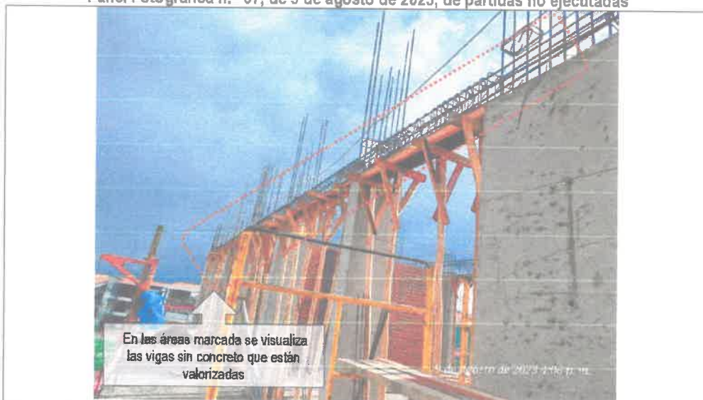
Imagen n.º 39 Panel Fotográfica n.º 07, de 9 de agosto de 2023, de partidas no ejecutadas
