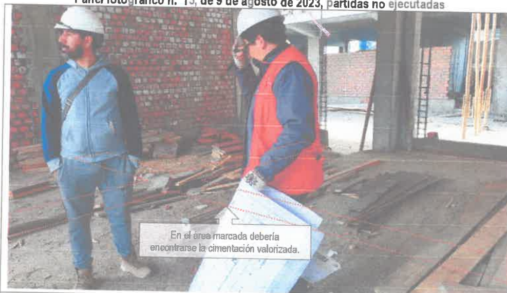
Imagen n.º54 Panel fotográfico n.º15, de 9 de agosto de 2023, partidas no ejecutadas
