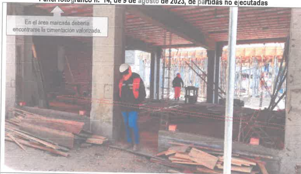
Imagen n.º53 Panel fotográfico n.º14, de 9 de agosto de 2023, de partidas no ejecutadas
