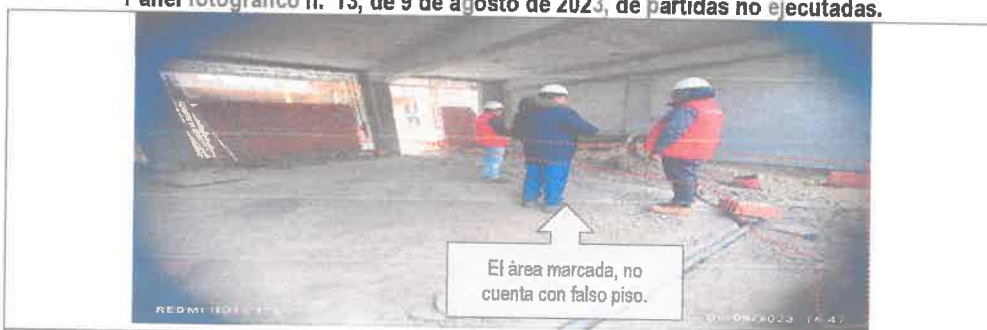
Imagen n.º 48 Panel fotográfico n.º 13, de 9 de agosto de 2023, de partidas no ejecutadas.
