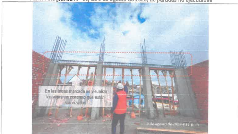
Imagen n.º 38 Panel Fotográfica n.º 06, de 9 de agosto de 2023, de partidas no ejecutadas
