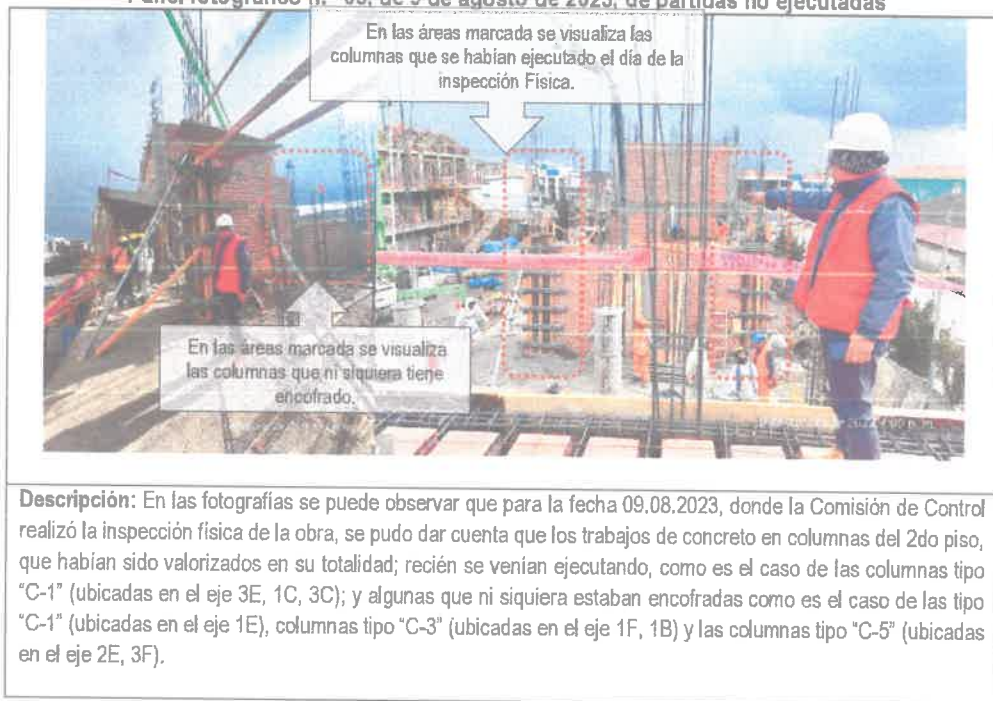
Imagen n.º37 Panel fotográfico n.º 05, de 9 de agosto de 2023, de partidas no ejecutadas
