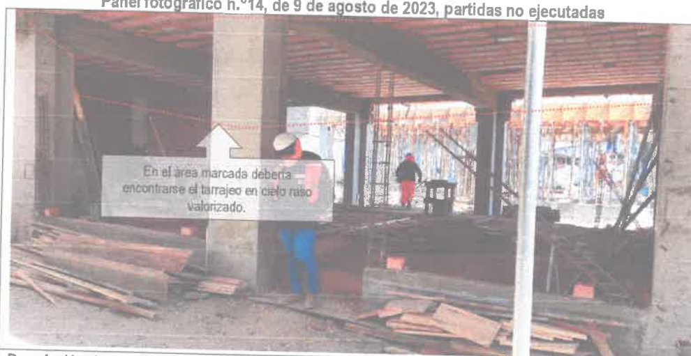
Imagen n.º 56 Panel fotográfico n.º14, de 9 de agosto de 2023, partidas no ejecutadas
