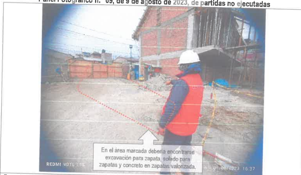
Imagen n.º 43 Panel Fotográfico n.º 09, de 9 de agosto de 2023, de partidas no ejecutadas
