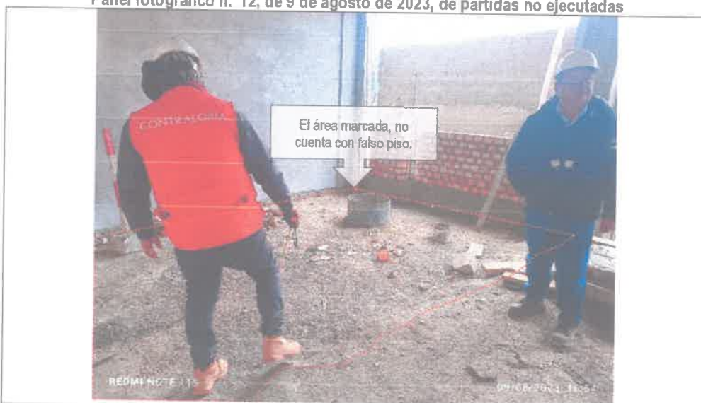
Imagen n.º 47 Panel fotográfico n.º 12, de 9 de agosto de 2023, de partidas no ejecutadas
