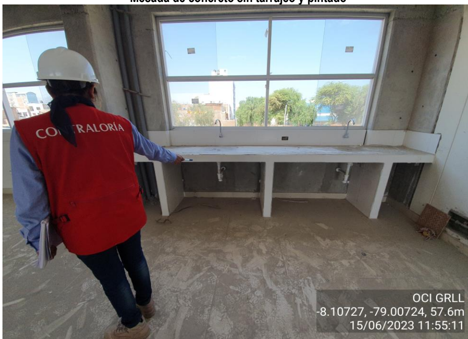
Imagen n.º 44 Mesada de concreto sin tarrajeo y pintado
