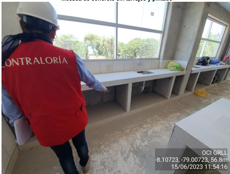
Imagen n.º 45 Mesada de concreto sin tarrajeo y pintado
