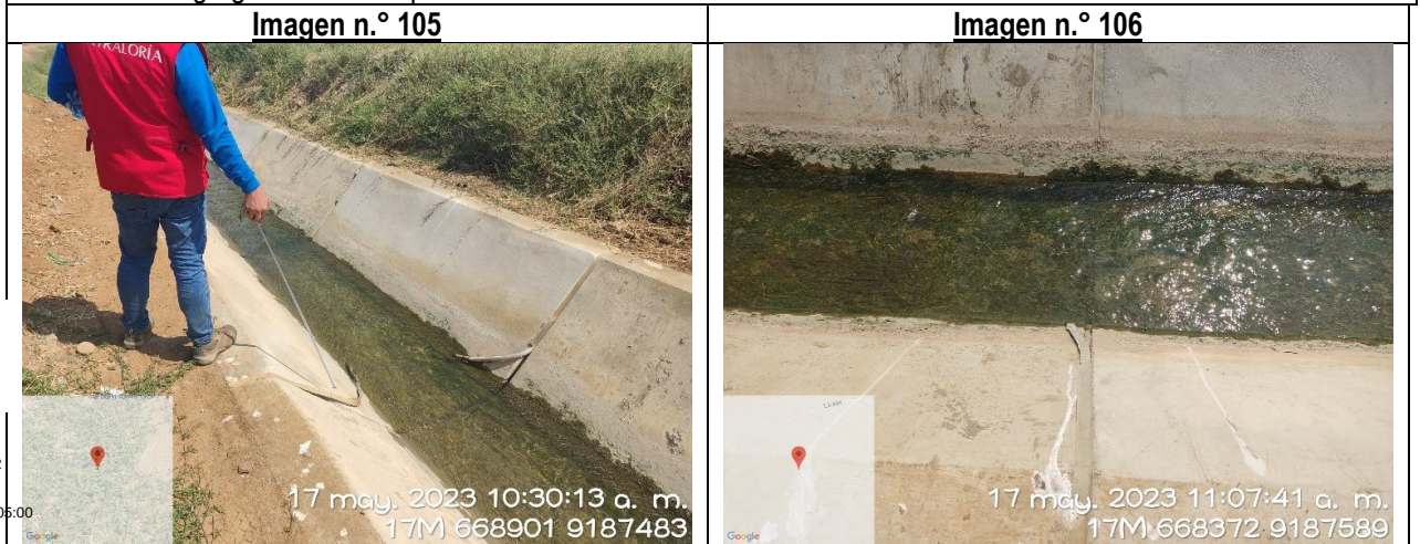
Se observó que el material elastomérico se esta desprendiendo de las juntas del canal.
