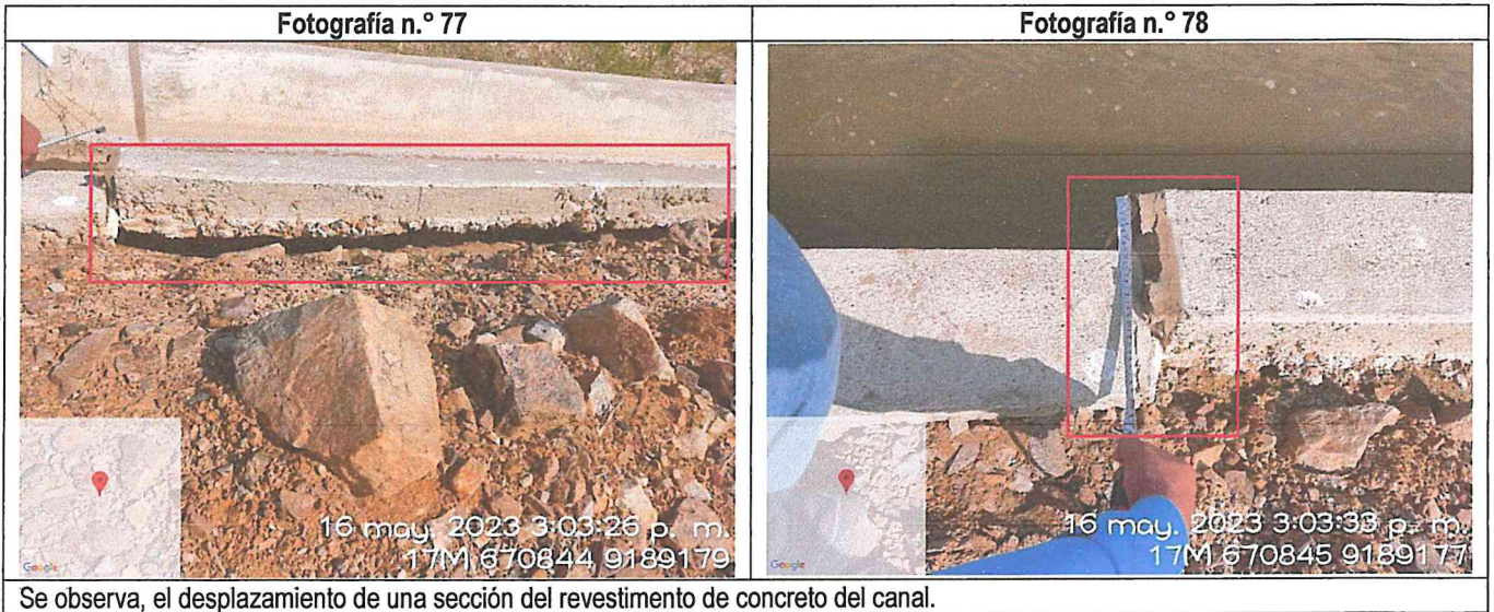
Se observa, el desplazamiento de una sección del revestimiento de concreto del canal.
