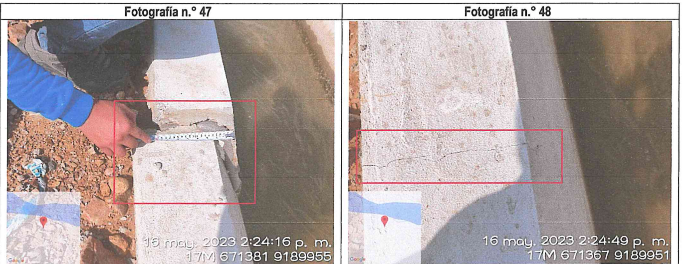
Se observa el asentamiento de un paño del revestimiento de concreto del canal y otro paño fisurado.
