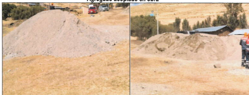
Imagen fotográfica n.º 7: Se observa agregados almacenados sobre el piso y en contacto con el terreno natural.
