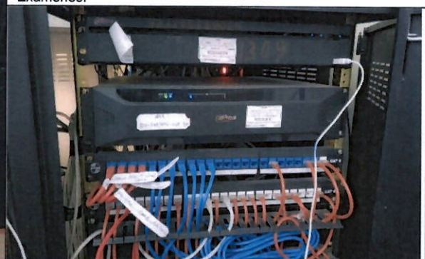
Imagen n.º26: Equipo de grabación NVR y conexiones de cámaras de video expuestas.
