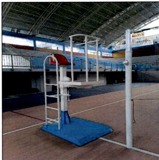
Silla torre para árbitro sin protección (acolchonado); asimismo los parantes para red de vóley no presenta protector.
