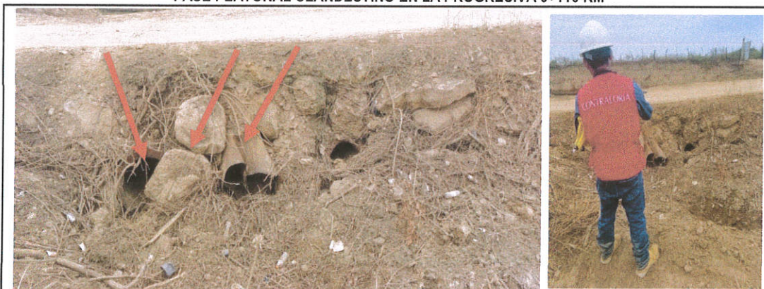
IMAGEN N° 06 Y 07 PASE PEATONAL CLANDESTINO EN LA PROGRESIVA 0+110 KM
