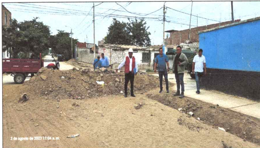
Fotografía n.º 4 Calle Leoncio Prado con desmonte, arena y basura
