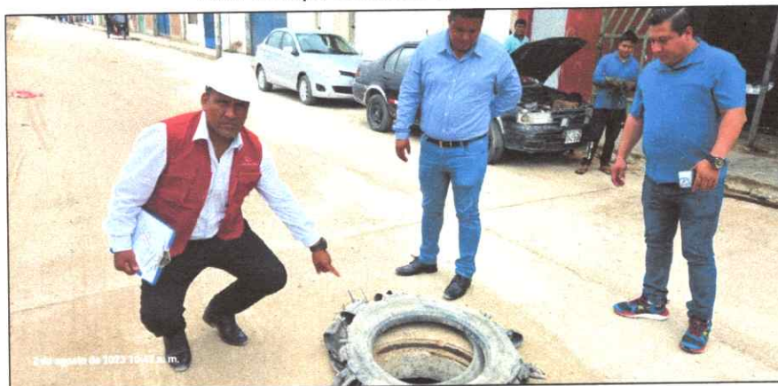
Fotografía n.º 1 Falta de tapa de buzón sin señalización
