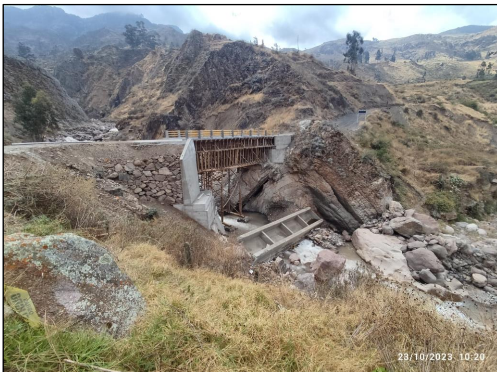
Imagen n.º 7 Inspección física de obra en el cual se encontró ausente el supervisor de obra
