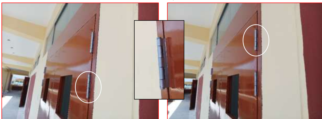
IMAGEN N° 23 BISAGRAS INSTALADAS CON EJES DE GIRO QUE SOBRESALEN HACIA EL EXTERIOR
