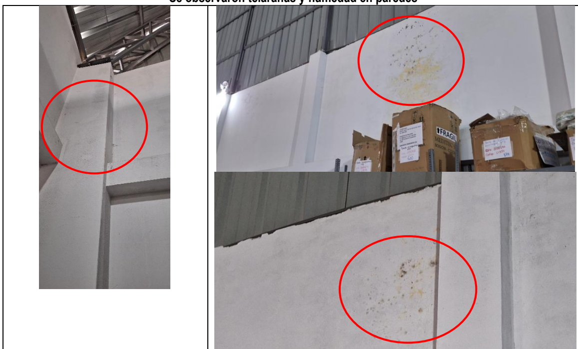
Panel fotográfico n.° 5 Se observaron telarañas y humedad en paredes
