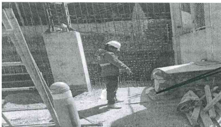
Imagen n.º 1 Vista del estado de conservación del Cemento
