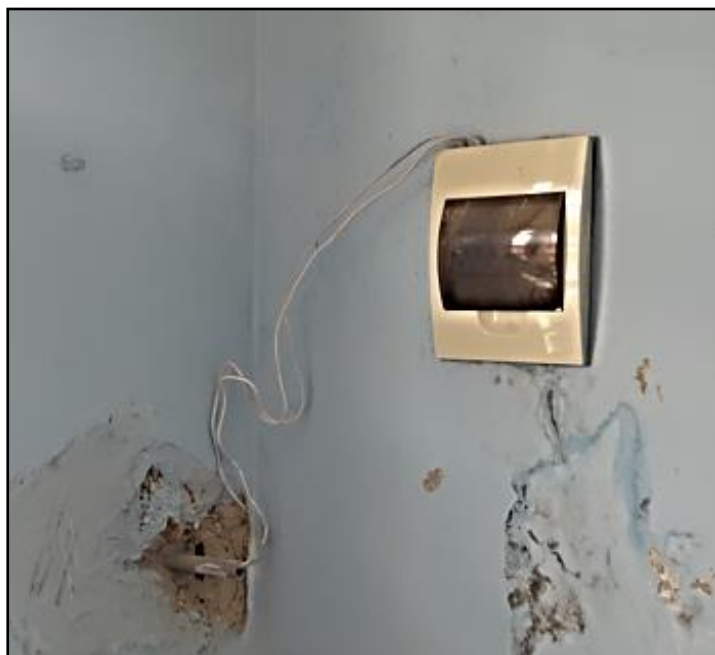
Imagen n.º 1 Cable expuesto
