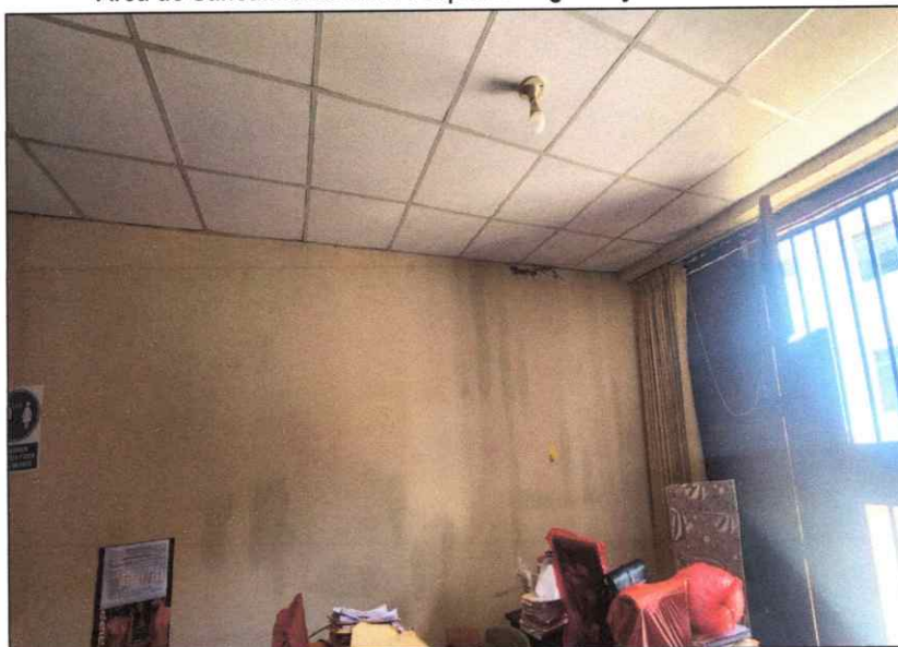
Fotografía 6: Se evidenció que, las paredes se encontraban húmedas, consecuencia de la filtración del agua pluvial.
