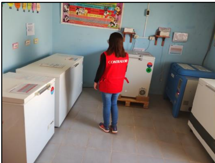
Fotografía n.º 9 Mobiliario con el que cuenta el ambiente de cadena de frío
