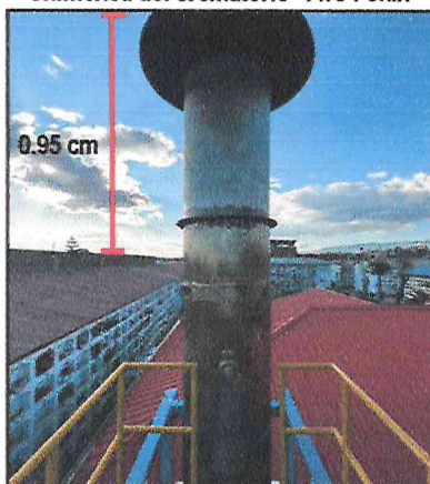
Imagen n.º 2 Chimenea del crematorio "Ave Fénix"
