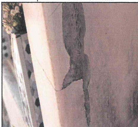
Imagen n.º 11 Desprendimiento de revestimiento
