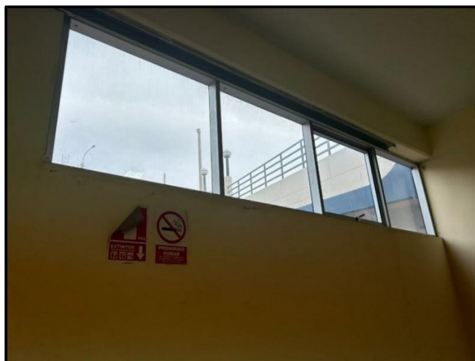
Imagen n.º 1 Ventilación inadecuada
