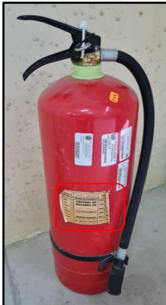
Imagen n.º 3 Extintor inoperativo, sin carga vigente
