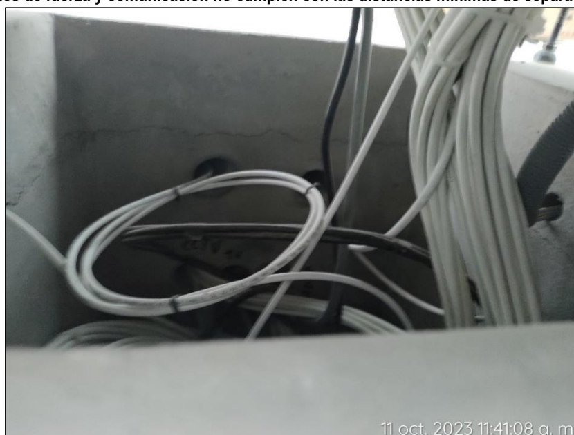
Imagen n.º 31 Cables de fuerza y comunicación no cumplen con las distancias mínimas de separación
