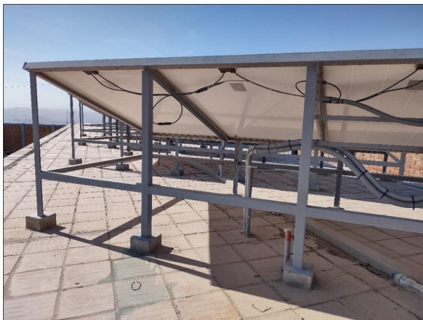
Imagen n.º 21 Estructura de soporte de arreglo del sistema fotovoltaico no está conectado al sistema de puesta a tierra
