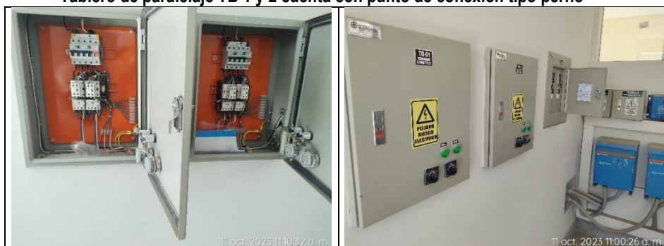
Imágenes n.ºs 29 y 30 Tablero de paralelaje TB 1 y 2 cuenta con punto de conexión tipo perno
