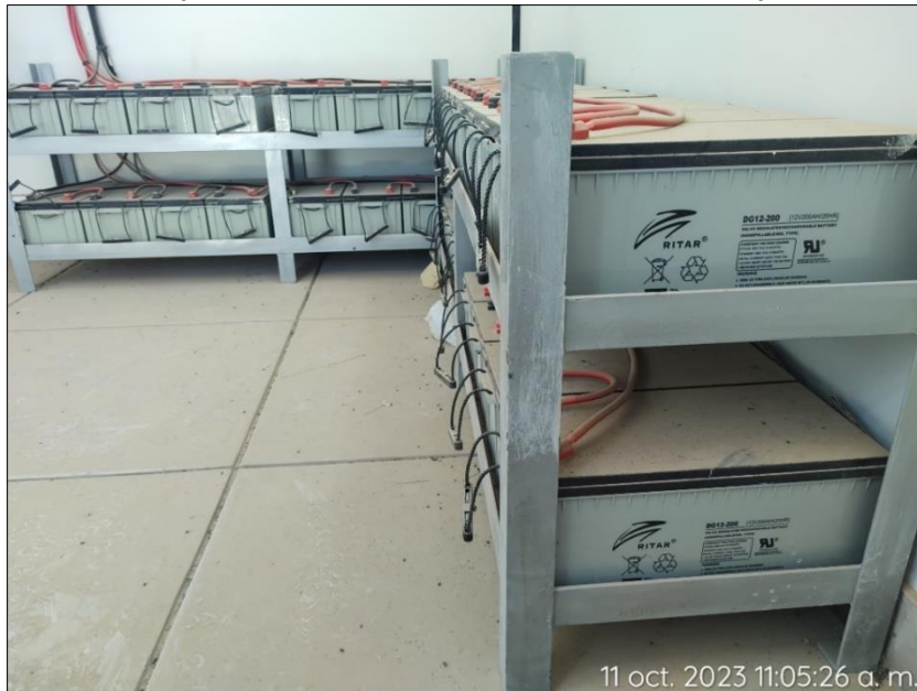
Imagen n.º 22 Estructura de soporte de baterías no está conectada al sistema de puesta a tierra
