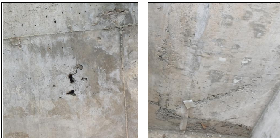
Imagen n.º 3 y 4 Vacios existentes en los muros del tercer filtro grueso ascendente del PTAP
