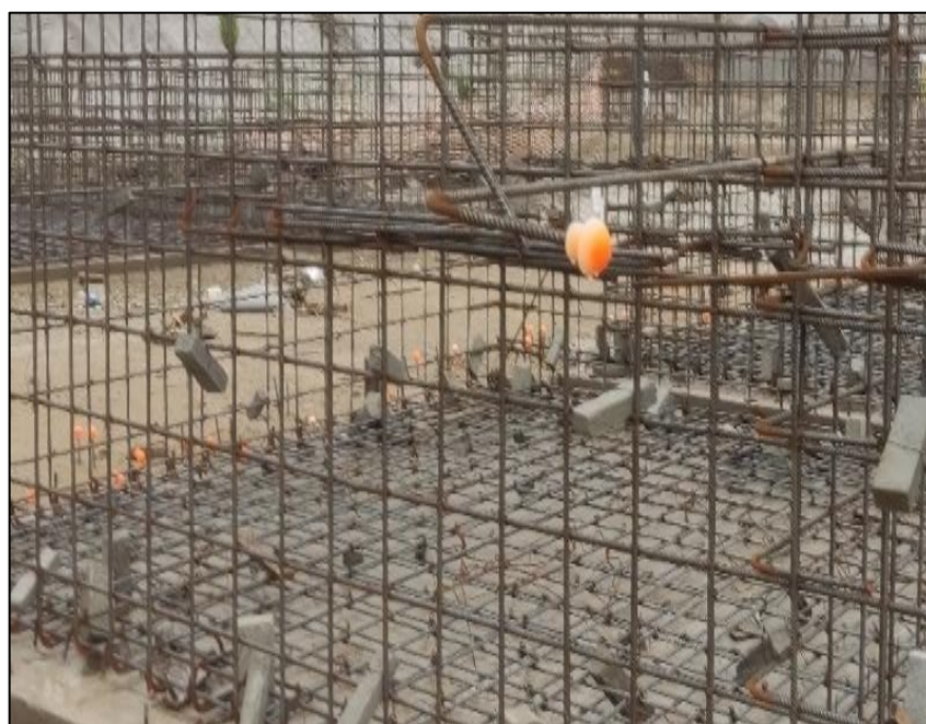
Imagen n.º 9 Vacios existentes en los muros del tercer filtro grueso ascendente del PTAP
