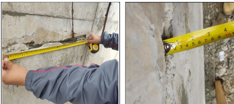
Imagen n.º 7 y 8 Acero expuesto y recubrimiento encontrado en un filtro grueso ascendente de la PTAP
