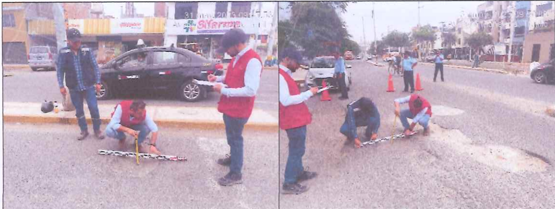
Descripción: Superficie (0.88 m 2 ), la profundidad del hueco es de 0.115 m. Se advierte desgaste de la capa de rodadura en un tramo.
