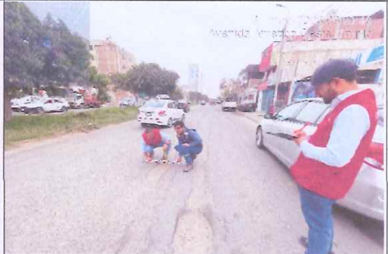
Descripción: Superficie (0.35 m 2 ), la profundidad del hueco es de 0.07 m. Se observa ahuellamiento, desprendimiento de finos, deterioro del pavimento.
