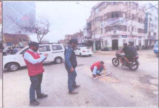
Descripción: Superficie (3.20 m 2 ), se advierte relleno del hueco con material residual (ladrillo) por pobladores de la zona.
