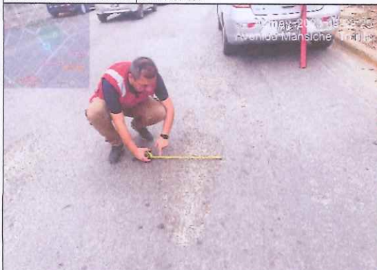
Descripción: Superficie con ahuellamiento es de 1.20 m2
