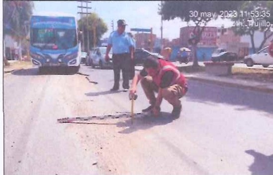
Descripción: Superficie (4.00 m 2 ), la profundidad del hueco es de 0.07 m.
