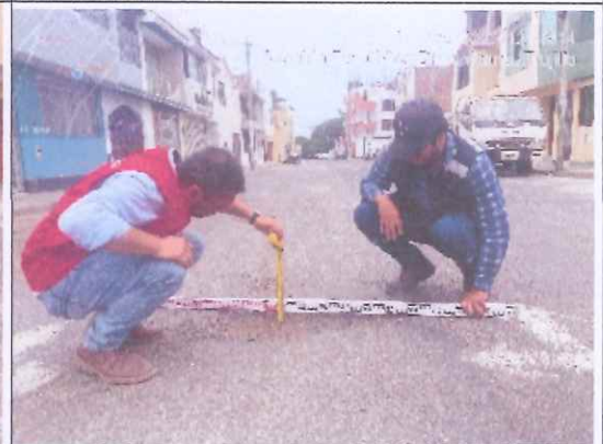
Descripción: Superficie (0.55 m 2 ), la profundidad del hueco es de 0.06 m.
