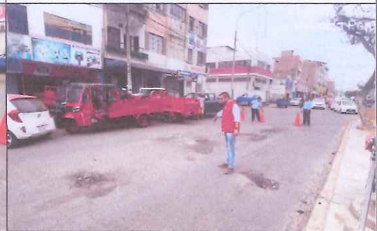
Descripción: Superficie (51.25 m 2 ), se observan huecos, desprendimiento de agregados.
