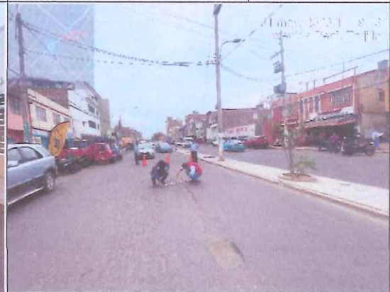
Descripción: Superficie (52.50 m 2 ), se observa ahuellamiento, huecos, y desprendimiento de agregados.
