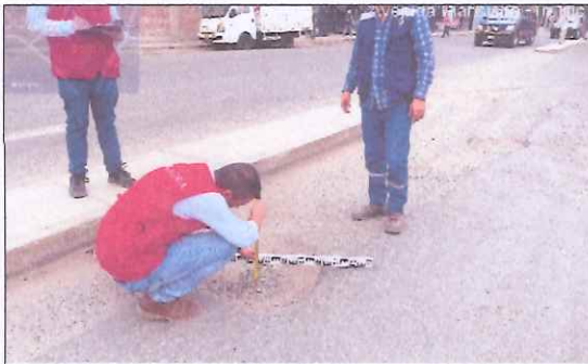
Descripción: Superficie (13.80 m 2 ), la profundidad del hueco es de 0.135 m.
