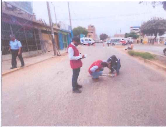
Descripción: Superficie (0.68 m 2 ), la profundidad del hueco es de 0.05 m.
