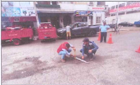
Descripción: Superficie (14.00 m 2 ), la profundidad del hueco es de 0.05 m. Se observa agrietamiento en bloque, desprendimiento de agregados.
