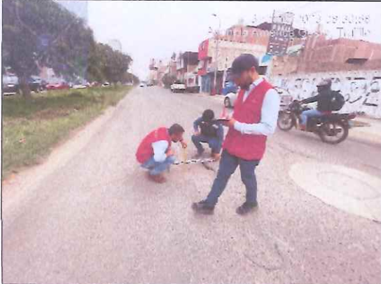
Descripción: Superficie (1.256 m 2 ), la profundidad del hueco es de 0.09 m. Se observa desprendimiento de agregado.
