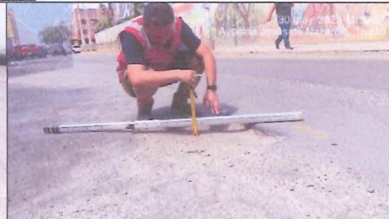
Descripción: Superficie (3.60 m 2 ), la profundidad del hueco es de 0.07 m. Deterioro del pavimento.
