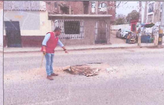
Descripción: Se advierte un hueco profundo relleno con material residual por los pobladores, probablemente producto del lavado de la base del pavimento por aguas de alcantarilla.
