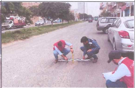
Descripción: Superficie (0.36 m 2 ), la profundidad del hueco es de 0.08 m. Se observa desprendimiento de agregados y deterioro del pavimento en el tramo.
