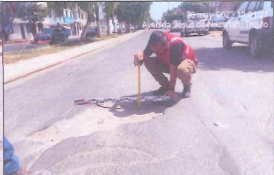
Descripción: Superficie (0.80 m 2 ), la profundidad del hueco es de 0.10 m.
