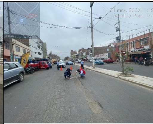
Descripción: Superficie (52.50 m 2 ), se observa ahuellamiento.
