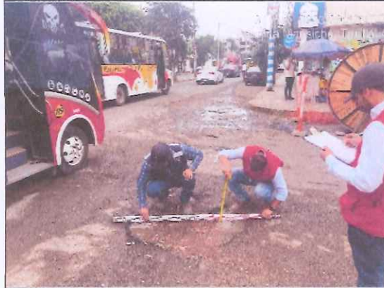
Descripción: Superficie (4.125 m 2 ), la profundidad del hueco es de 0.07 m. Se advierte lavado de finos en el área (exposición de agregado grueso).
