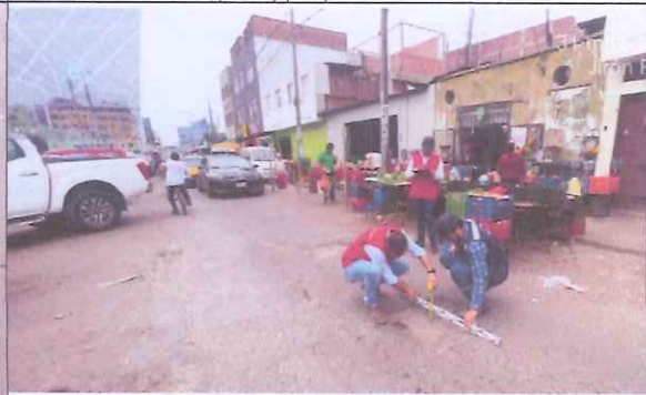
Descripción: Superficie (24.00 m 2 ), se observa el desprendimiento de agregados.
