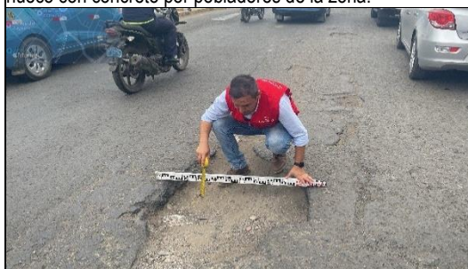
Descripción: Superficie (2.40 m 2 ), la profundidad del hueco es de 0.135 m.
