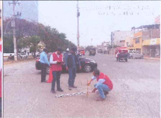
Descripción: Superficie (5.39 m 2 ), la profundidad del hueco es de 0.12 m. Se advierte desgaste en el área (exposición de agregado grueso).
