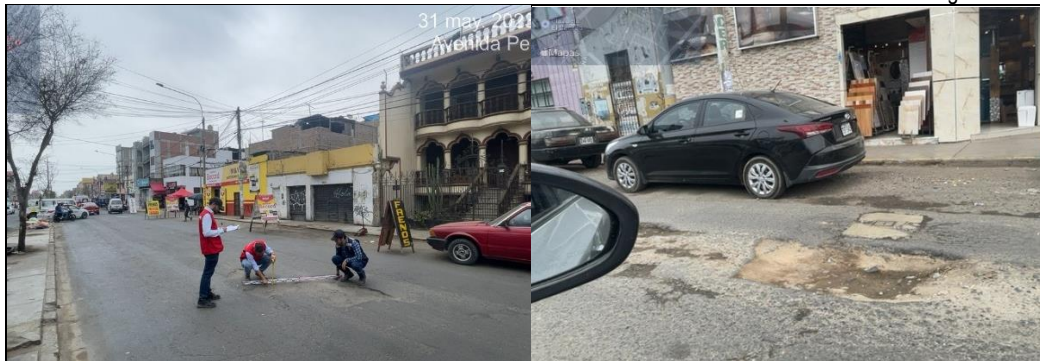
Descripción: Superficie (7.50 m 2 ), se advierte relleno del hueco con concreto por pobladores de la zona.
