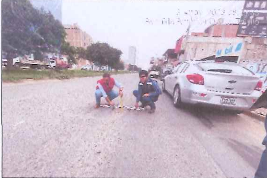
Descripción: Superficie (0.675 m 2 ), la profundidad del hueco es de 0.075 m. Se observa ahuellamiento y desprendimiento de finos.
