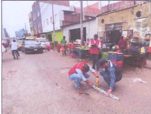
Descripción: Superficie (1.44 m 2 ), la profundidad del hueco es de 0.12 m. Se advierte desprendimiento de agregaos en el área.
