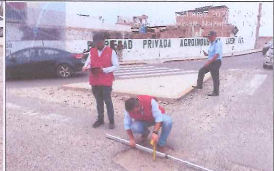
Descripción: Superficie (1.650 m 2 ), la profundidad del hueco es de 0.10 m. Se observa deterioro del pavimento en el tramo.
