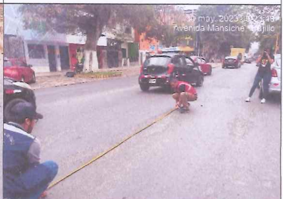
Descripción: Superficie con ahuellamiento es de 2.20 m2
