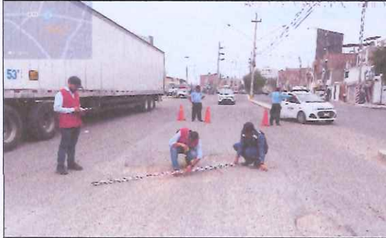
Descripción: Superficie (5.00 m 2 ), la profundidad del hueco es de 0.09 m.
