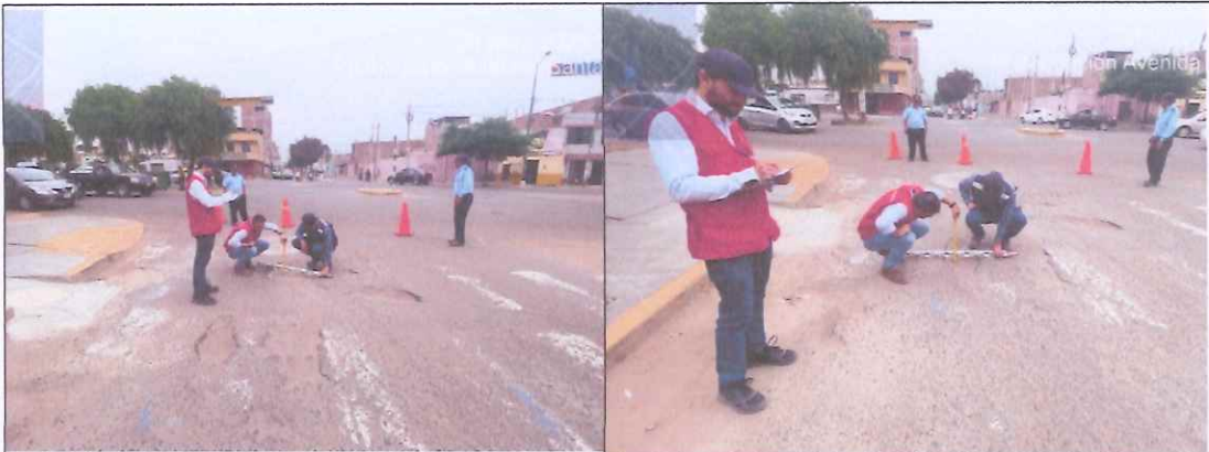
Descripción: Superficie (1.76 m 2 ), la profundidad del hueco es de 0.07 m.
