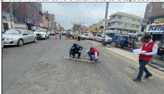
Descripción: Superficie (200.00 m 2 ) se advierte ahuellamiento en la capa de rodadura.
