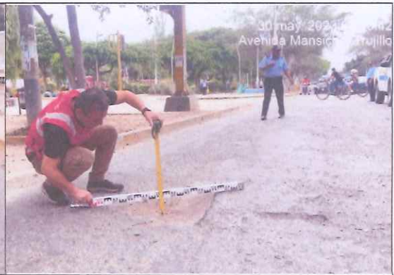
Descripción: Superficie (0.81 m2), la profundidad del hueco es de 0.11 m. Se observa deterioro del pavimento.
