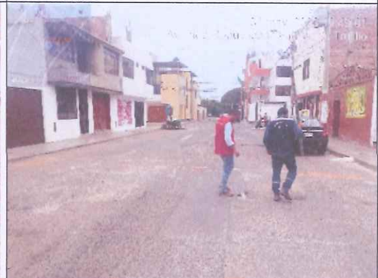
Descripción: Se observan huecos así como desprendimiento de agregados.
