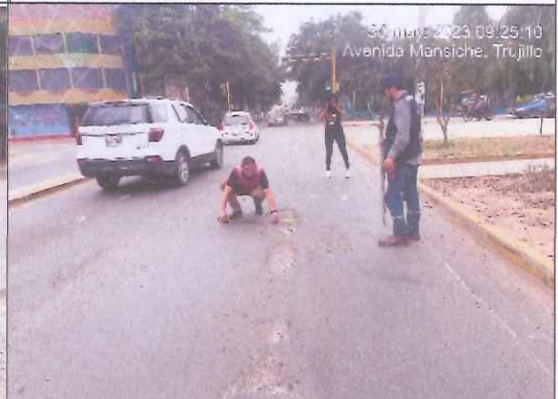
Descripción: Superficie con ahuellamiento es de 25.00 m2
