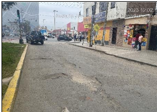
Descripción: Superficie fallada (37.50 m 2 ), existencia de huecos.
