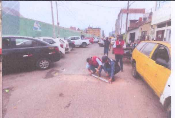
Descripción: Superficie (2.65 m 2 ), la profundidad del hueco es de 0.10 m. Se advierte desgaste en el tramo. Se advierte desprendimiento de agregaos en el área.
