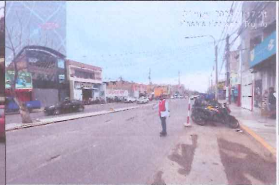
Descripción: Superficie (175.00 m 2 ), se observa ahuellamiento, levantamiento de la carpeta asfáltica.
