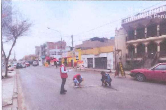
Descripción: Superficie (7.50 m 2 ), se advierte relleno del hueco con concreto por pobladores de la zona.
