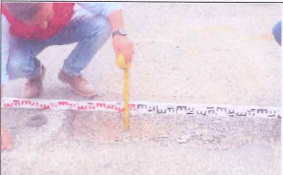
Descripción: Superficie (45.00 m 2 ), la profundidad del hueco es de 0.07 m.
