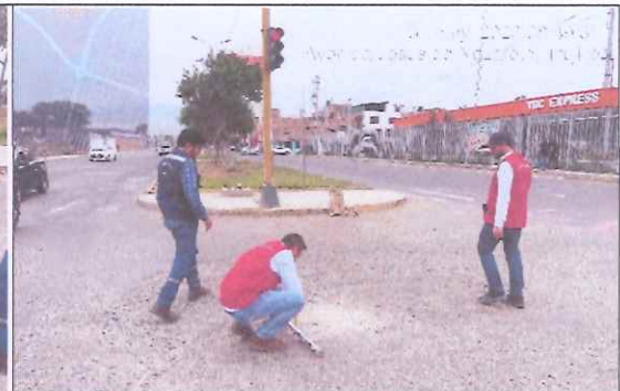
Descripción: Superficie (4.26 m 2 ), la profundidad del hueco es de 0.05 m.
