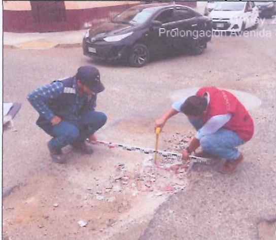
Descripción: Superficie (4.20 m 2 ), la profundidad del hueco es de 0.12 m.
