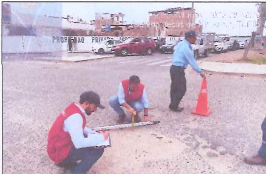
Descripción: Superficie (3.60 m 2 ), la profundidad del hueco es de 0.075 m.
