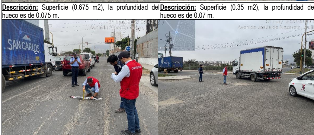
Descripción: Superficie (0.113 m 2 ), la profundidad del hueco es de 0.055 m. Se observa grietas longitudinales, desprendimiento de finos. Descripción: En la intersección con Av. Jesús de Nazareno se observa la existencia de huecos, desprendimiento de agregados.
