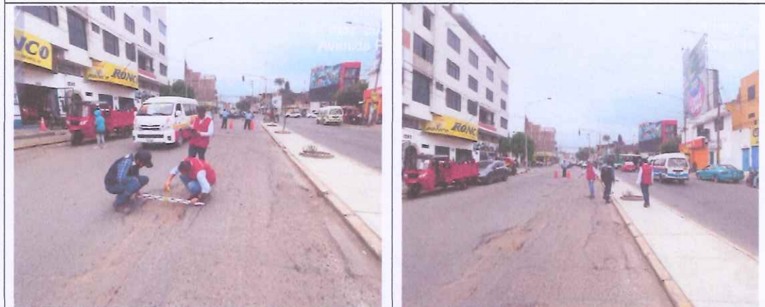
Descripción: Superficie (3.30 m 2 ), la profundidad del hueco es de 0.09 m.
