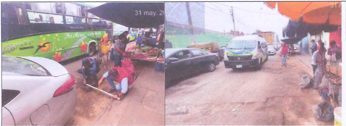
Descripción: Superficie (2.80 m 2 ), la profundidad del hueco es de 0.14 m.
