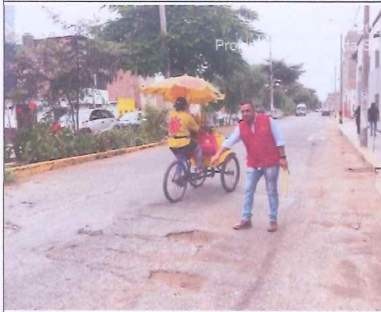
Descripción: Superficie (11.40 m 2 ), existencia de huecos, ahuellamiento en bloque y desprendimientos de agregados.
