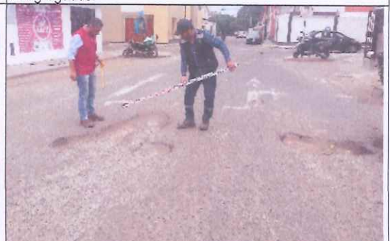
Descripción: Superficie (9.00 m 2 ), la profundidad del hueco es de 0.10 m.
