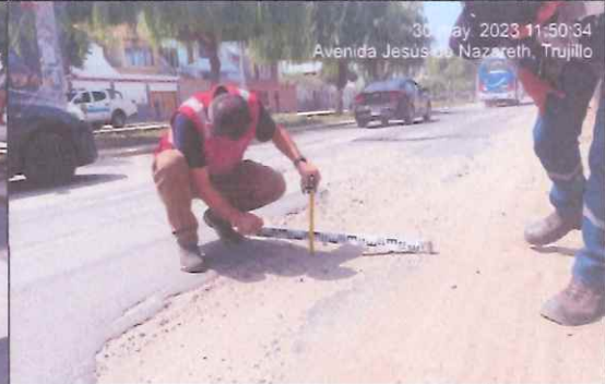
Descripción: Superficie (5.00 m 2 ), la profundidad del hueco es de 0.07 m. Deterioro del pavimento.
