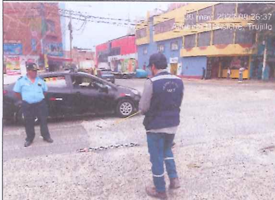
Descripción: Superficie con ahuellamiento es de 80.00 m2. Se observa deterioro del pavimento.
