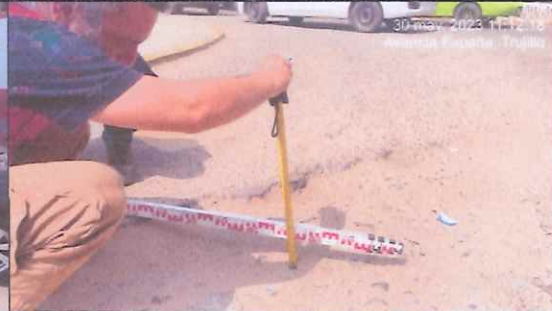
Descripción: Superficie (45.00 m 2 ), la profundidad del hueco es de 0.07 m.
