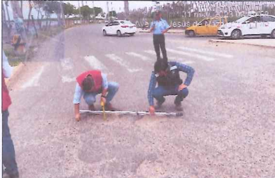
Descripción: Superficie (1.650 m 2 ), la profundidad del hueco es de 0.11 m. Se observa desprendimiento de finos.
