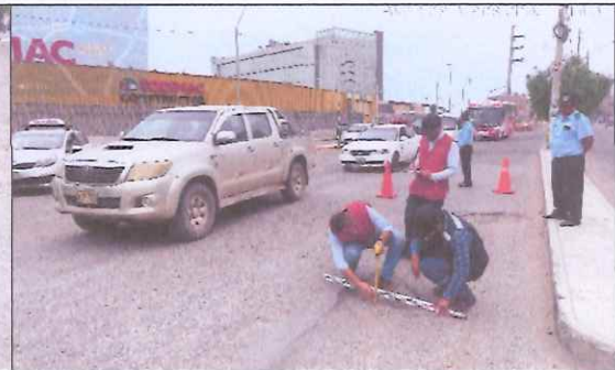
Descripción: Superficie (12.50 m 2 ), la profundidad del hueco es de 0.11 m.
