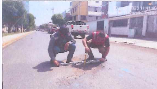
Descripción: Superficie (0.60 m 2 ), la profundidad del hueco es de 0.07 m.
