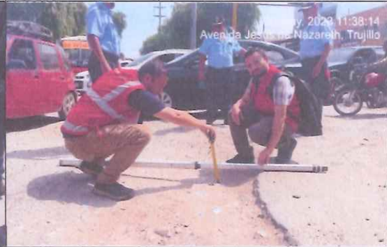
Descripción: Superficie (9.00 m 2 ), la profundidad del hueco es de 0.10 m.
