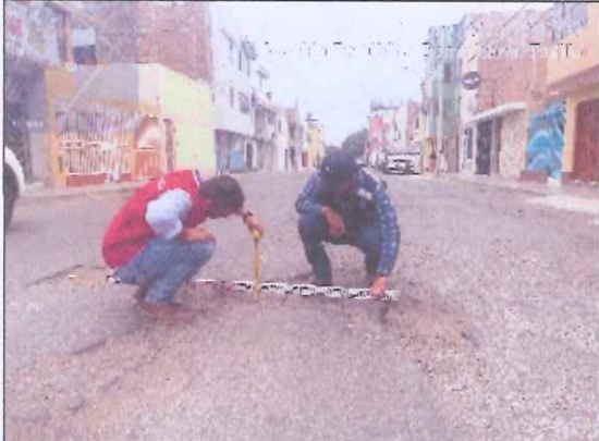
Descripción: Superficie (3.125 m 2 ), la profundidad del hueco es de 0.07 m.
