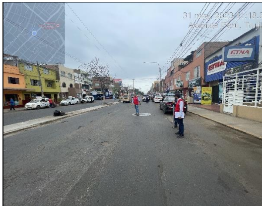
Descripción: Superficie (182.00 m 2 ), se advierte ahuellamiento así como levantamiento de la capa asfáltica.
