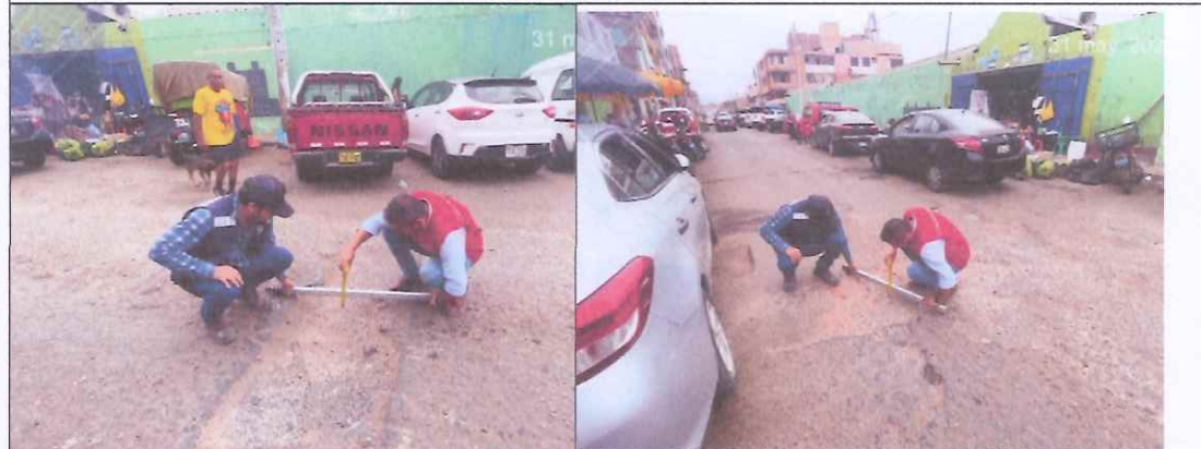
Descripción: Superficie (1.25 m 2 ), la profundidad del hueco es de 0.10 m.
