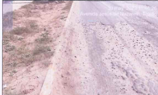
Descripción: Desplazamiento del pavimento flexible hacia la jardinera, lo que genera huecos entre el sardinel y la calzada, el área fallada es 12.00 m 2 . Deterioro del pavimento.
