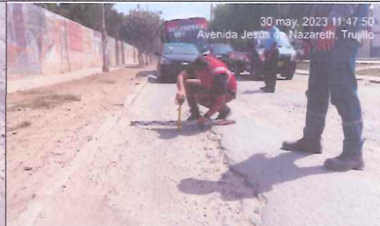
Descripción: Desplazamiento del pavimento flexible hacia la jardinera, lo que genera huecos entre el sardinel y la calzada, el área fallada es 18.00 m 2 . Deterioro del pavimento.
