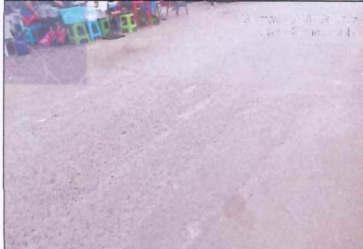
Descripción: Superficie (10.50 m 2 ), se observa la pérdida o desprendimiento de agregados.
