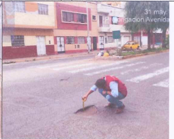
Descripción: Superficie (0.40 m 2 ), la profundidad del hueco es de 0.12 m.
