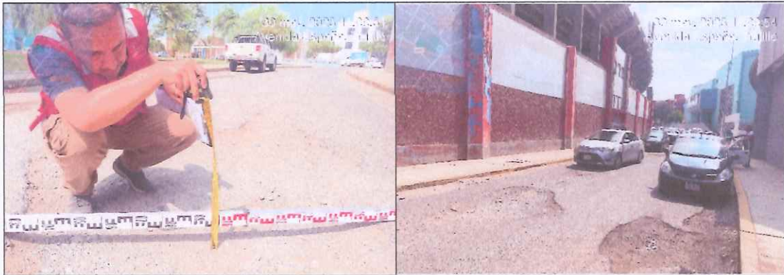
Descripción: Superficie (9.00 m 2 ), la profundidad del hueco es de 0.06 m. Deterioro del pavimento.
