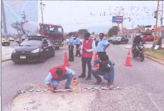
Descripción: Superficie (1.256 m 2 ), la profundidad del hueco es de 0.09 m. Se observa deterioro por desprendimiento de finos.
