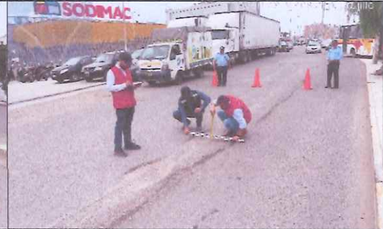
Descripción: Se advierte ahuellamiento con huecos en el tramo aproximado de 120 m lineales. Profundidad del hueco es de 0.06m. Además, se advierte desgaste del pavimento en todo el ancho de la vía.
