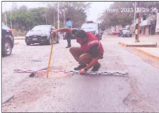
Descripción: Superficie (0.72 m2), la profundidad del hueco es de 0.12 m. Se observa deterioro del pavimento.
