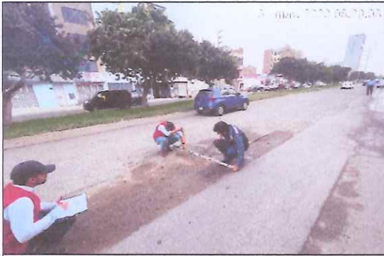
Descripción: Superficie con hueco con una profundidad de hueco es de 0.13 m.
