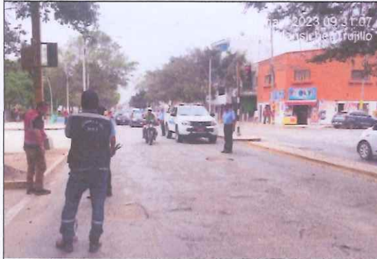
Descripción: Superficie con ahuellamiento, huecos y deterioro del pavimento es de 280.00 m2.
