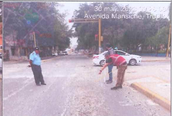
Descripción: Superficie con ahuellamiento y deterioro del pavimento es de 60.00 m2.
