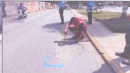
Descripción: Superficie (7.00 m 2 ), la profundidad del hueco es de 0.04 m.
