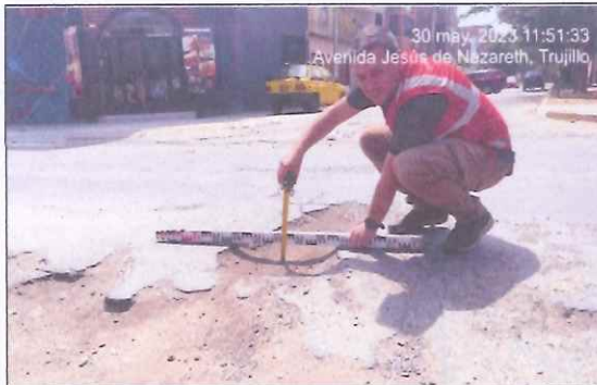
Descripción: Superficie (8.50 m 2 ), la profundidad del hueco es de 0.07 m. Deterioro del pavimento.
