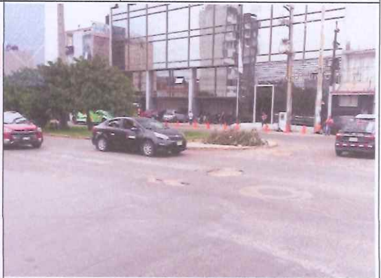
Descripción: Se observa la existencia de varios huecos en intersección con Calle 8, a la altura de Torre UPAO.
