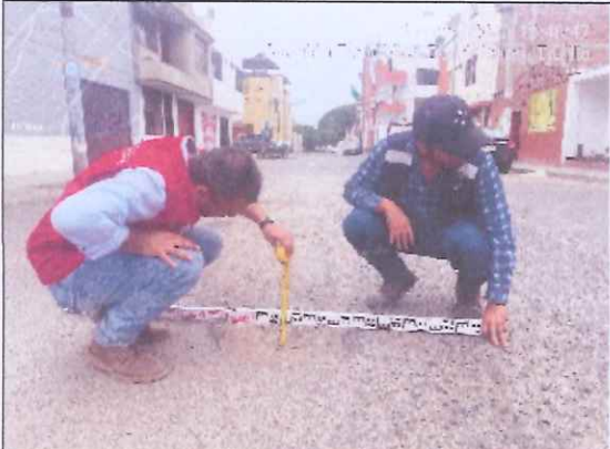
Descripción: Superficie (0.55 m 2 ), la profundidad del hueco es de 0.10 m.
