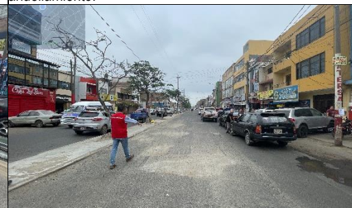
Descripción: Se advierte ahuellamiento en la capa de rodadura.
