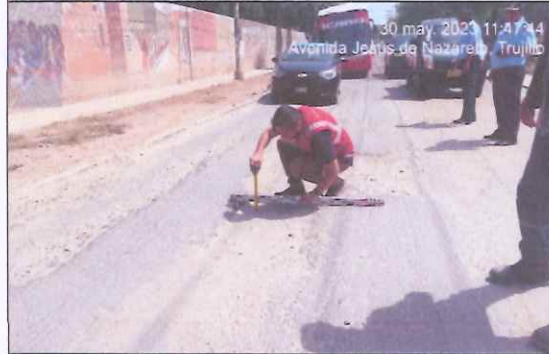
Descripción: Superficie (45.00 m 2 ), la profundidad del hueco es de 0.07 m.
