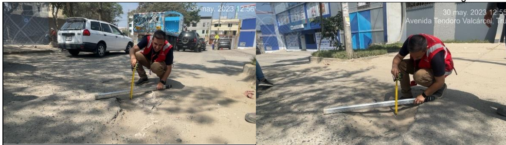
Descripción: Superficie (4.50 m 2 ), la profundidad del hueco es de 0.08 m. Deterioro del pavimento. Descripción: Superficie (3.40 m 2 ), la profundidad del hueco es de 0.10 m.
