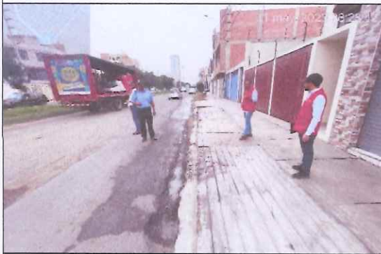
Descripción: Se observa fallas de borde de la calzada en una longitud de 20 m.
