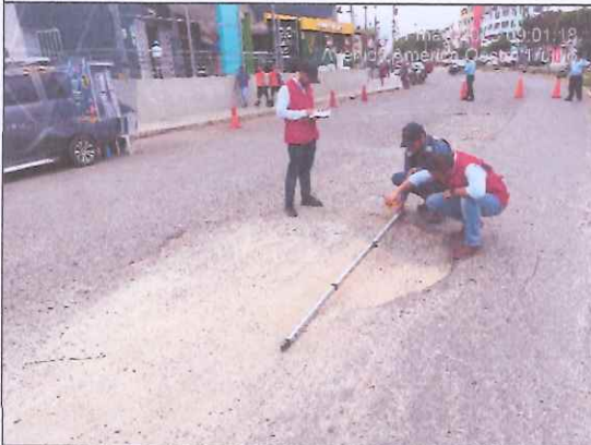
Descripción: Superficie (5.50 m 2 ), la profundidad del hueco es de 0.11 m. Se observa deterioro del pavimento en el tramo.
