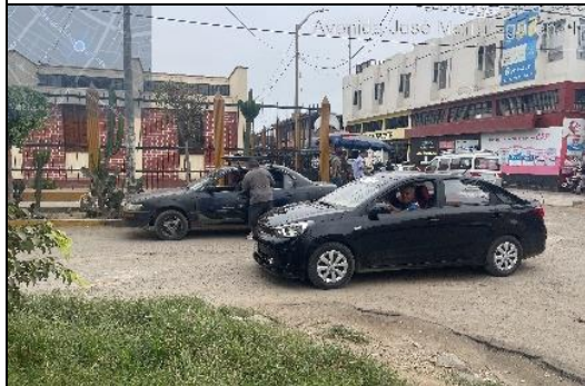
Descripción: Superficie (1.40 m 2 ), se observa hueco en el borde a la vía.
