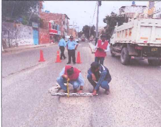
Descripción: Superficie (1.440 m 2 ), la profundidad del hueco es de 0.08 m. Se advierte desgaste del pavimento en todo el ancho de la vía en el tramos (80 m)
