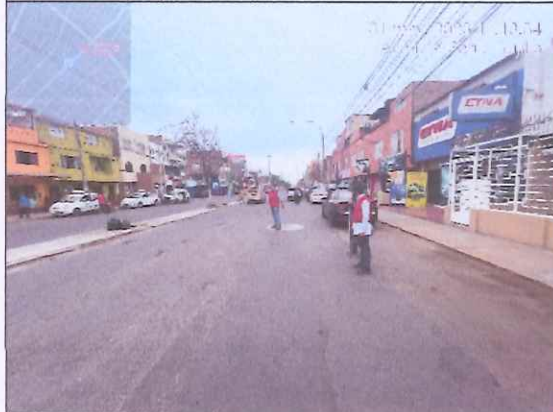
Descripción: Superficie (182.00 m 2 ), se advierte desprendimiento de agregados, ahuellamiento así como levantamiento de la capa asfáltica.
