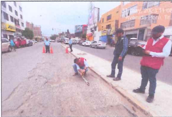
Descripción: Superficie (62.50 m 2 ), se aprecian huecos, baches, agrietamiento en bloque, desgaste del pavimento.
