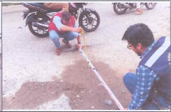
Descripción: Superficie con hueco y desprendimiento de agregados es de 20.00 m 2 . Profundidad de hueco es de 0.12 m.
