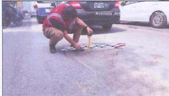
Descripción: Superficie (1.50 m 2 ), la profundidad del hueco es de 0.08 m. Deterioro del pavimento.
