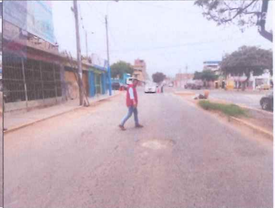
Descripción: Superficie (1.80 m 2 ), se advierte relleno del hueco con concreto por pobladores de la zona.
