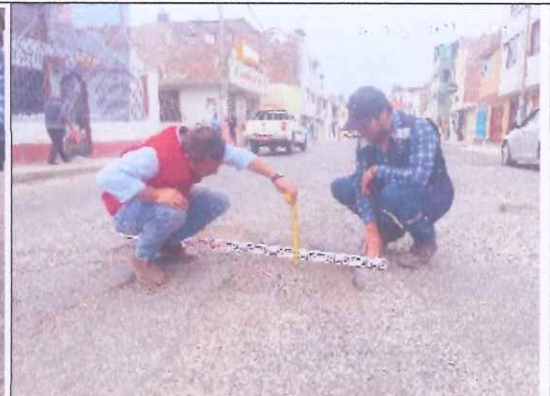
Descripción: Superficie (1.98 m 2 ), la profundidad del hueco es de 0.055 m.
