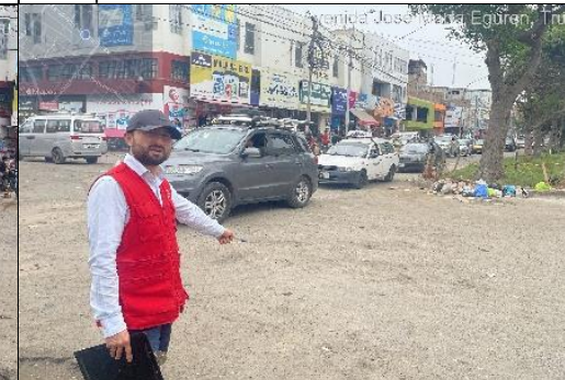
Descripción: Superficie (240.00 m 2 ), existencia de huecos en intersección.
