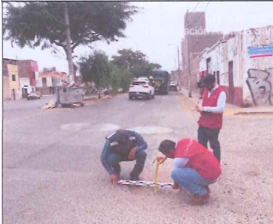
Descripción: Superficie (9.00 m 2 ), la profundidad del hueco es de 0.13 m.
