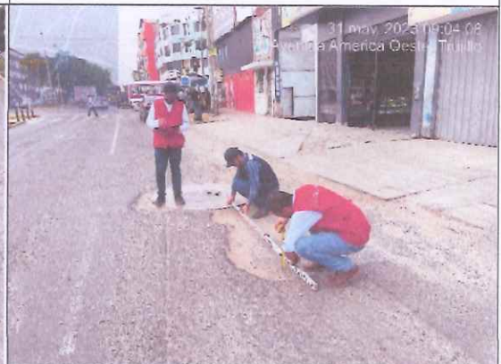
Descripción: Superficie (2.80 m 2 ), la profundidad del hueco es de 0.10 m, además el desprendimiento de finos.
