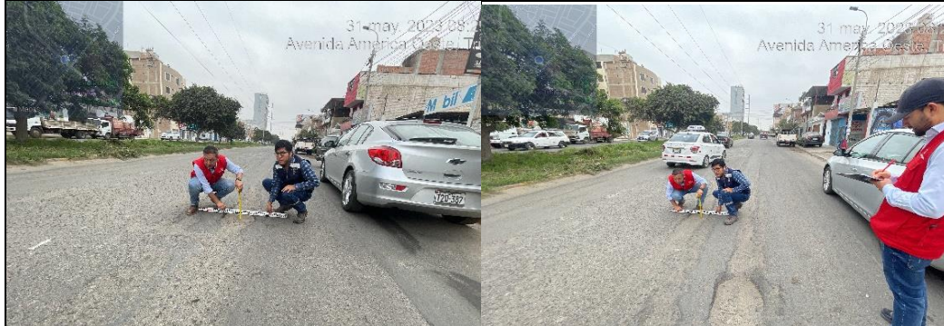
Descripción: Superficie (0.675 m 2 ), la profundidad del hueco es de 0.075 m. Descripción: Superficie (0.35 m 2 ), la profundidad del hueco es de 0.07 m.
