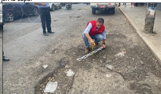
Descripción: Superficie (21.00 m 2 ), se observa huecos en la capa de rodadura.
