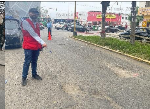
Descripción: Superficie (21.60 m 2 ), se observan huecos en la capa de rodadura.
