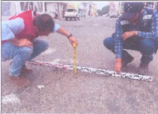
Descripción: Superficie (0.96 m 2 ), la profundidad del hueco es de 0.05 m.
