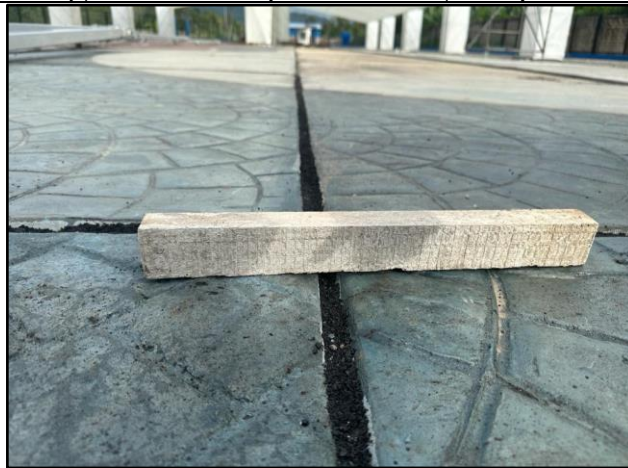
Se observa que el sellado de juntas no llega al borde de la superficie del piso.
