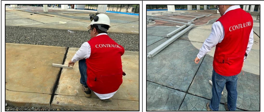
Juntas de dilatación de veredas y pisos en la Obra con juntas de dilatación por debajo del nivel de superficie.
