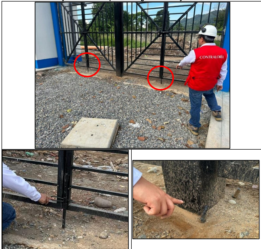
Panel fotográfico n.º 2 Cerrojos verticales sin punto de llegada metálico y columna metálica
