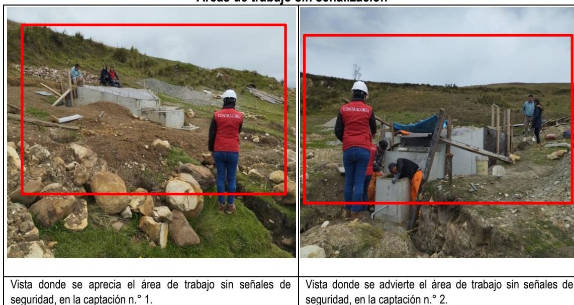
Imagen n.° 1 y 2 Áreas de trabajo sin señalización
